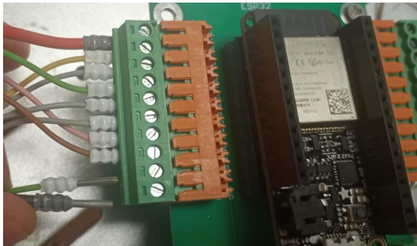
Figura 4.1.3: Terminales y cables crimpados de la PCB
