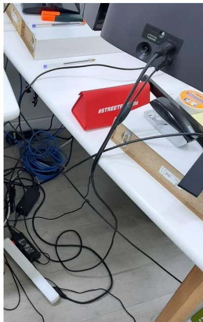
Figura 18. Puesto de trabajo con cableado bajo mesa.
