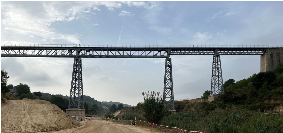
Figura 10. Vista de la parte derecha del Viaducto del Quisi desde aguas abajo. Fuente: Elaboración propia
