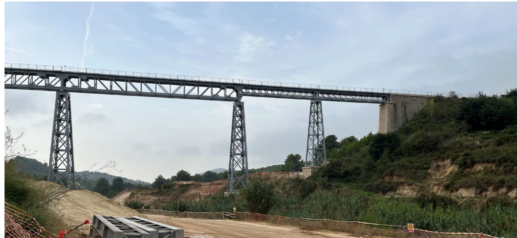
Figura 11. Detalle de pilas con su cruz de San Andrés y del tablero con celosía tipo Pratt. Fuente: Elaboración propia
