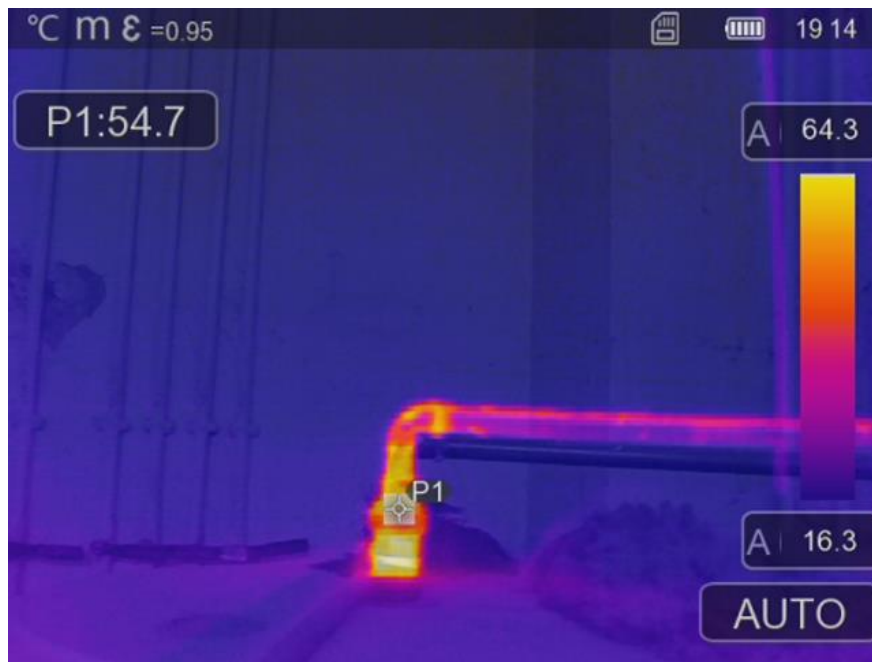
Figura 36: Termografía Tubería de salida del Termo
