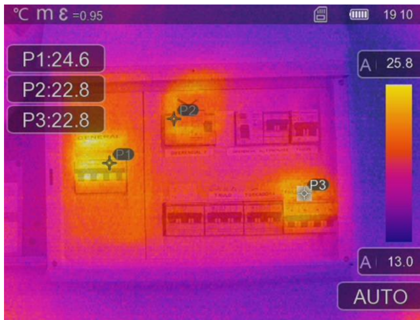
Figura 40: Termografía Cuadro General
