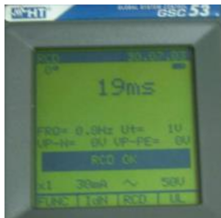
Figura 22: Prueba de diferencial monofásico
