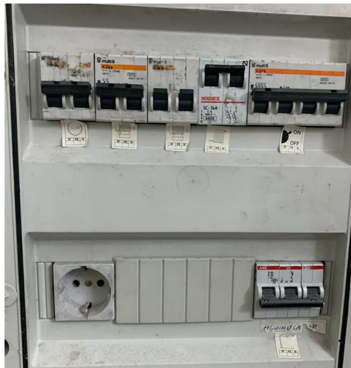
Figura 5: Cuadro secundario suministro agua caliente
