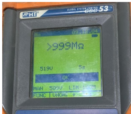
Figura 19: Medida de corrientes de fuga
