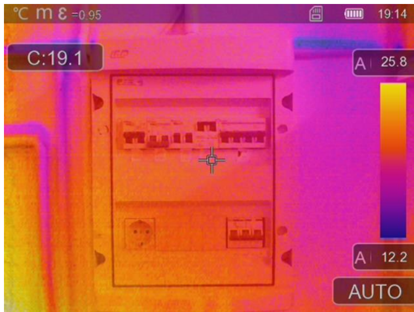
Figura 41: Termografía Cuadro secundario suministro agua caliente
