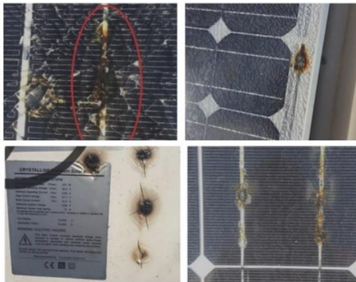
Ilustración 15: Fallo de Hot-Spot en placas solares [44].
