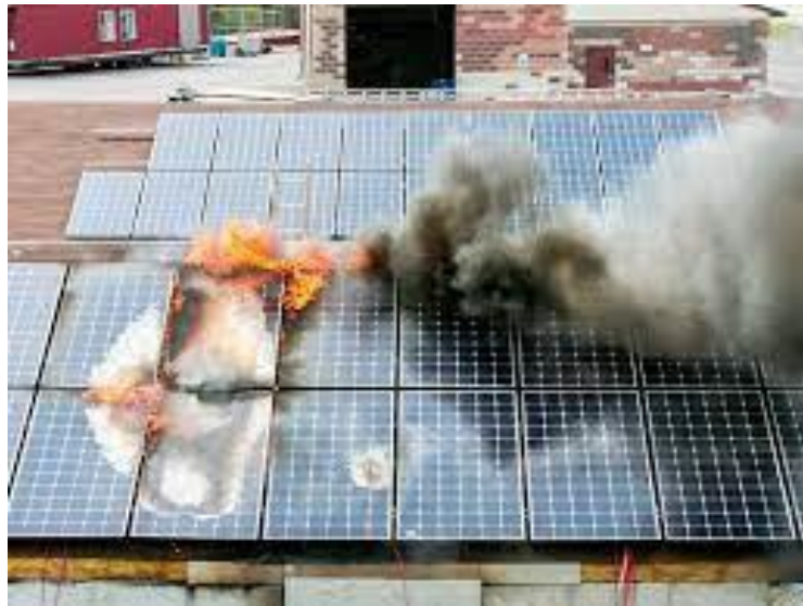
Il·lustració 16: Incendio de un sistema fotovoltaico [45].
