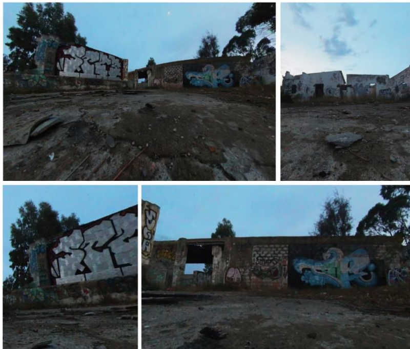
Construcció enderrocada de la platja de Puçol.
