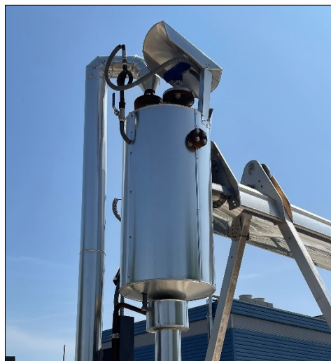
Figura 11: Steam drum de la instalación
