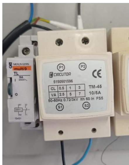
Ilustración 77 Transformador de corriente utilizado
