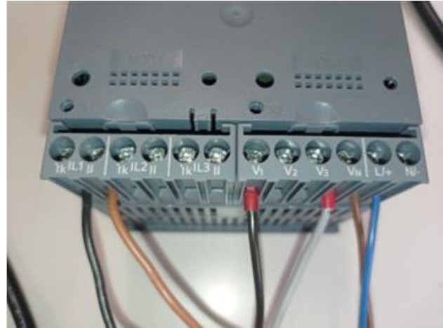
Ilustración 76 Conexión del PAC4200 para medición de la carga monofásica (PAC4200 Power monitoring Device, 2019)
