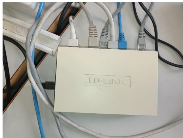
Ilustración 75 Cables RJ45 conectados al switch de ethernet
