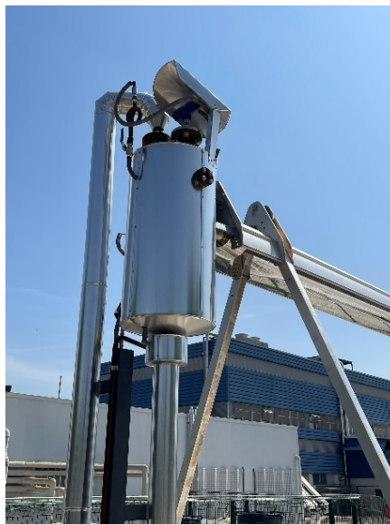
Figura 23. Steam Drum instalado en MicroGENVASOL
