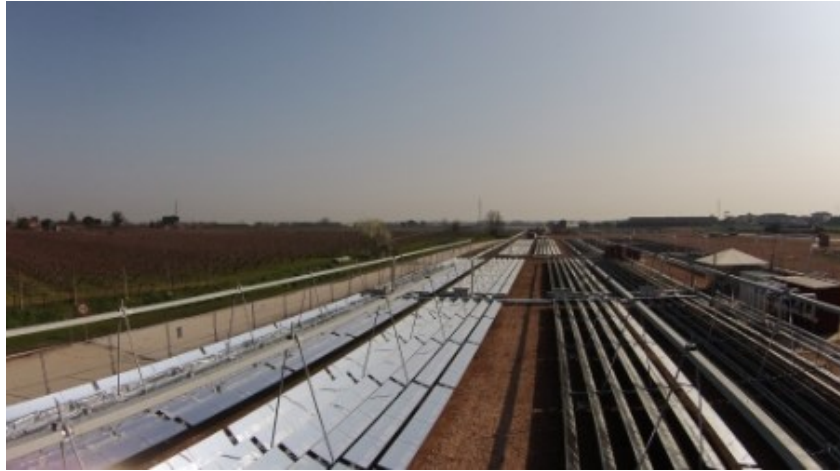
Figura 13. Instalación Linear Fresnel para SHIP de Soltigua [46]
