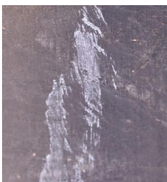
Figura 24. Detalle mancha de pintura.
