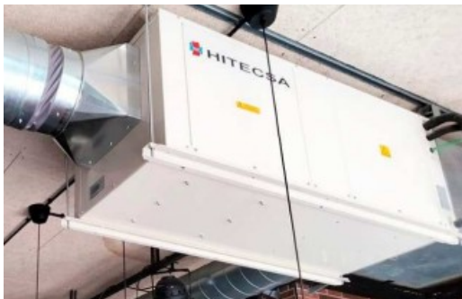
Imagen 10. Bomba de calor tipo – Fuente: Orekaintalaciones
