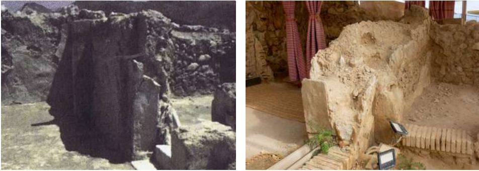
Figura 9.04 y 9.05. Muro de tapia en el yacimiento de Medina Siyasa (Cieza), durante su exposición (izquierda, 1993), y tras la erosión, lavado y colapso parcial por ausencia de protección (derecha, 2022).
