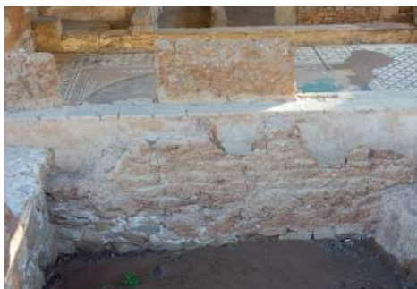
Figura 4.29. Muros de adobe en el yacimiento de La Casa del Mitreo (Mérida, 2022).
