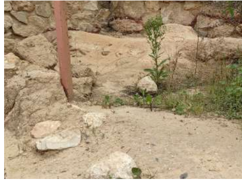
Figura 5.17. Ataluzado y pérdida volumétrica en la ciudad ibérica de Calafell (Calafell, 2022).
