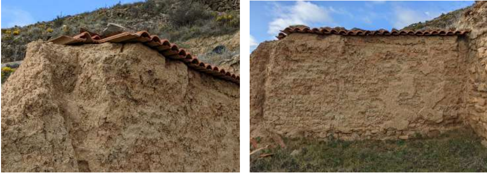
Figura 9.29 y 9.30. Sombrero mediante tejas cerámicas en las domus romanas de Bilibis (Calatayud, 2022), cuyo colapso en extremo ha facilitado la escorrentía concentrada de agua (izquierda, 2022).
