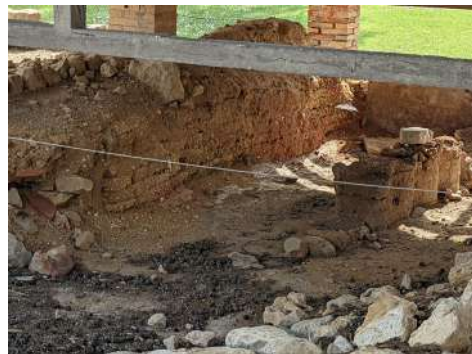
Figura 5.19. Socavación de base en horno griego de Ampurias (San Martín de Ampurias, 2022).
