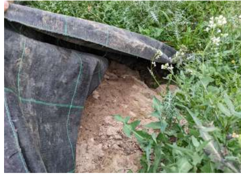
Figura 9.108. Humedad bajo cubrimiento textil en muro de la Illa d'en Reixac (Ullastret, 2022).
