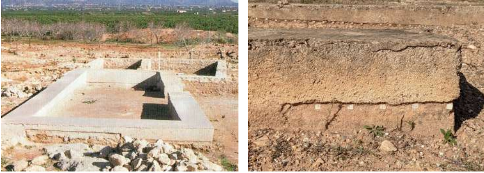
Figura 9.62 y 9.63. Restauración mediante técnicas diferentes (hormigón de cal) en la alquería islámica de Bofilla (Bétera), durante su ejecución (izquierda, 1981-1991) y en la actualidad (derecha, 2022).
