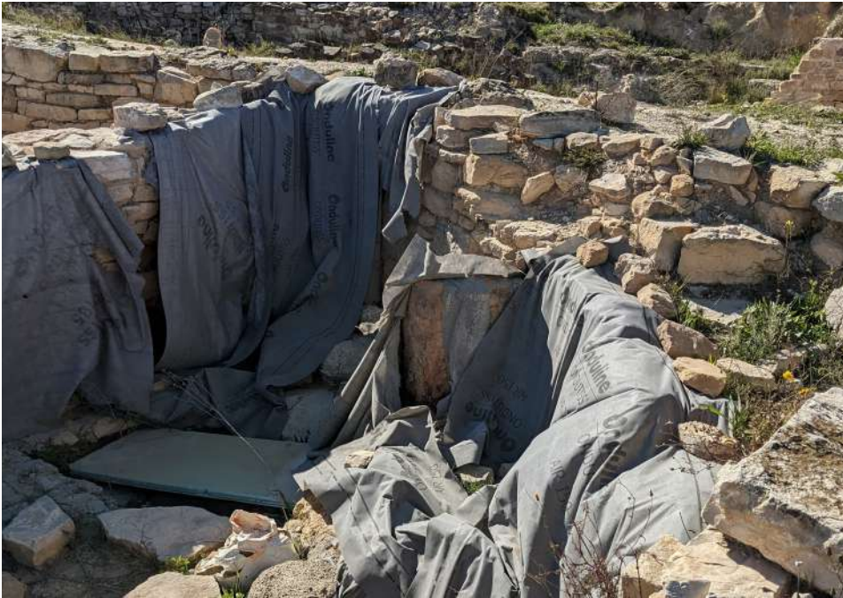
Figura 9.109. Cubrimiento mediante membranas impermeables de polipropileno, transpirables al vapor, si bien se advierte humedad capilar en los elementos, en el Coll del Moro (Gandesa, 2022).
