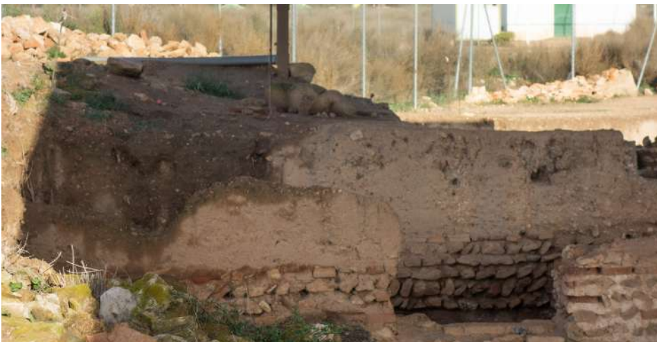
Figura 6.31. Tapia cubierta parcialmente, con coronación afectada por precipitaciones tras jornada de lluvias, en el yacimiento romano de Los Torrejones (Yecla, 2022).
