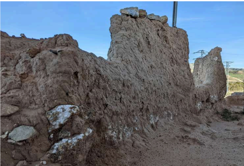
Figura 5.20. Ataluzado de alzados, pérdida volumétrica de zócalos y eflorescencias en estancias del yacimiento arqueológico de Contrebia Belaisca (Botorríta, 2022).
