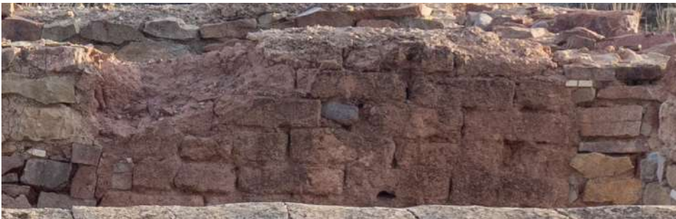
Figura 9.07. Muro de adobes en el yacimiento del Castellat de Bernabé (Llíria, 2023), tras la exposición prolongada y sin intervención, dada su cocción en origen por exposición a altas temperaturas.
