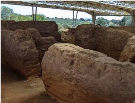
Figura 5.22. Erosión eólica en coronaciones de Cancho Roano (Zalamea de la Serena, 2022)
