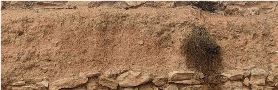
Figura 9.06. Muro de adobes en vivienda adosada a muralla del Tos Pelat (Moncada, 2022), actualmente expuesta a la intemperie y sin intervenciones de protección, a la espera de dichas labores.
