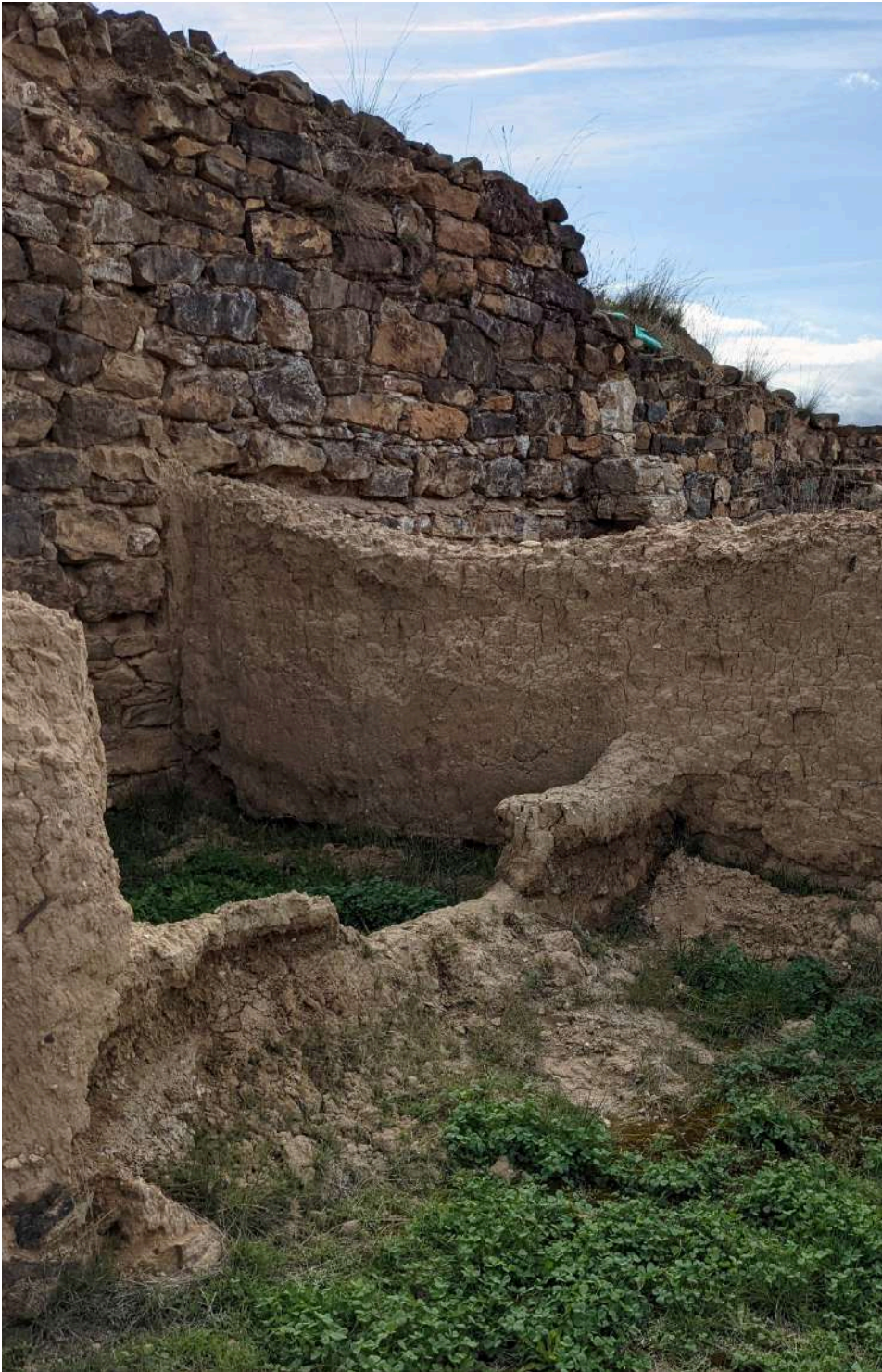
Figura 11.01. Socavación de bases y ataluzado en la casa del Ninfeo de Bílbilis (Calatayud, 2022).
