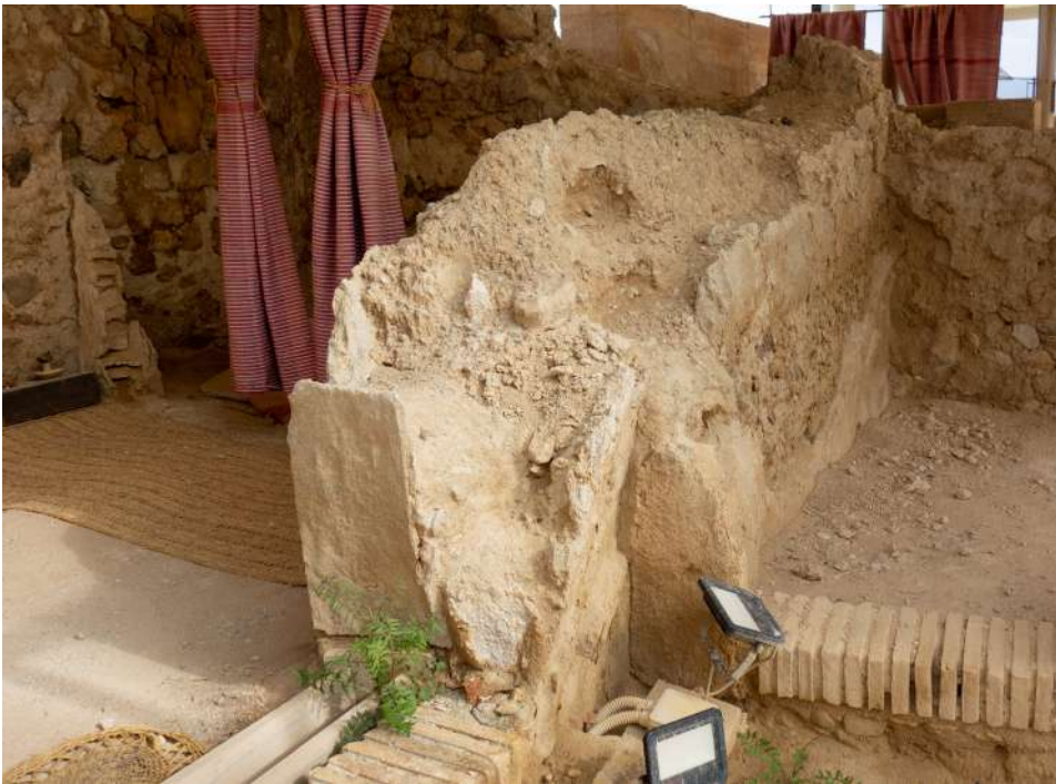
Figura 5.36. Rotura de esquina y desplome de superficie vertical por desconexión de revestimientos y pérdida de sección resistente en Medina Siyasa (Cieza, 2022).
