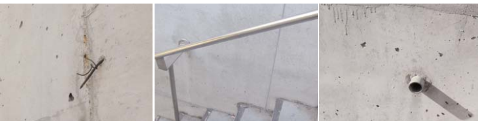
Algunos condicionantes previos del estado del muro, a tener en cuenta antes de cualquier intervención.
