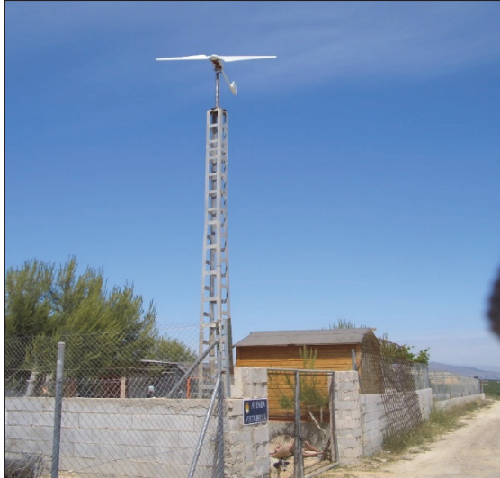
Figura 2. Instalaciones eólicas aisladas. Fuente: Aven
