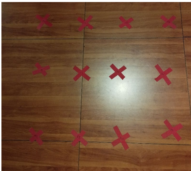
Figura 25 Muestreo de los puntos de medición en la sala de control, situados todos en torno al “sweet spot”.
