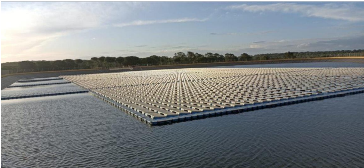
Imagen 5. Planta fotovoltaica flotante de la comunidad de regantes de Sur-Andévalo en Huelva.
