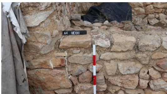
Figura 30. Mur UE1011 de l'àmbit A4, el qual presenta un enfosquiment del formigó de calç en la part superior. Font: Arxiu del GRAP.
