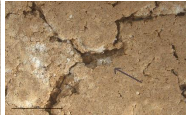
Figura 67. Detall a x10 de la superfície de la proveta M1-OL-75ARB. Font: Fotografia de l'autora.
