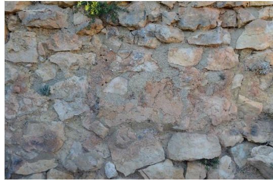
Figura 37. Detall del resultat del bisellat del revestiment situat a la part dreta del mur. Font: Arxiu del GRAP.
