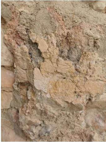
a) Detall de l'estat inicial del revestiment.
