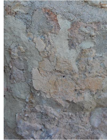
c) Detall de l'estat del revestiment sis mesos després de l'aplicació.
