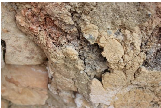
Figura 34. Detall de la separació entre el revestiment i el mur i les fissures en la capa de revestiment. Font: Arxiu del GRAP.
