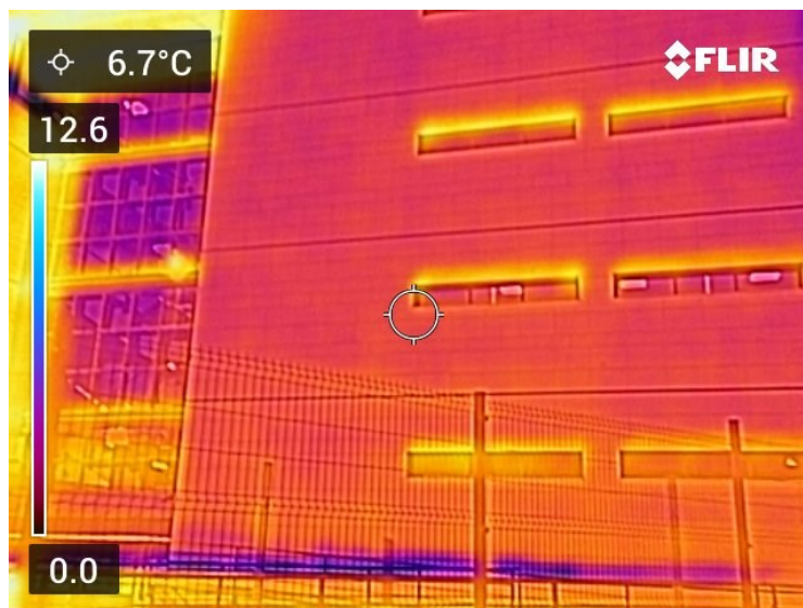
Figura 13. Puentes térmicos debidos a ventanas por la fachada este.
