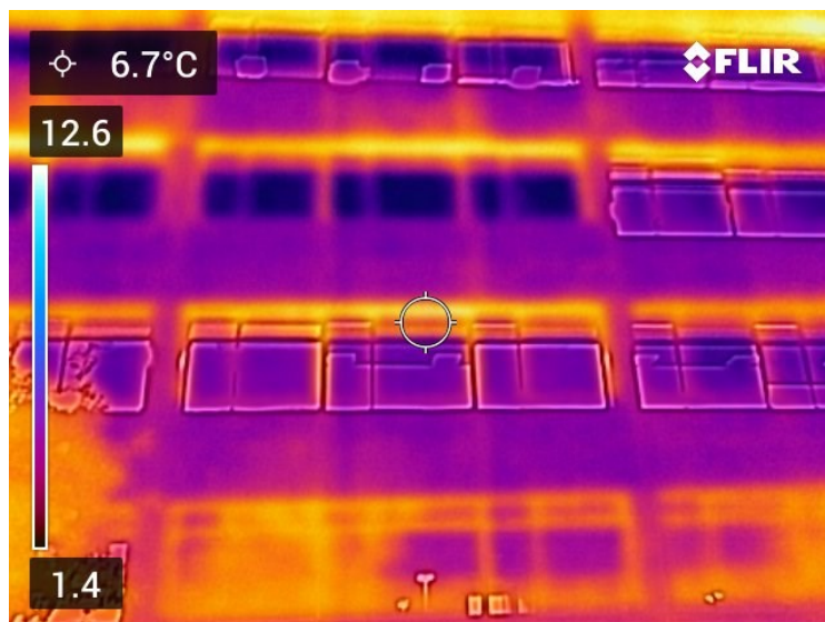
Figura 14. Puentes térmicos debidos a ventanas por la fachada norte.
