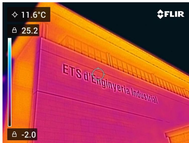
Figura 12. Puentes térmicos debido a cubierta, visto por la fachada sur.
