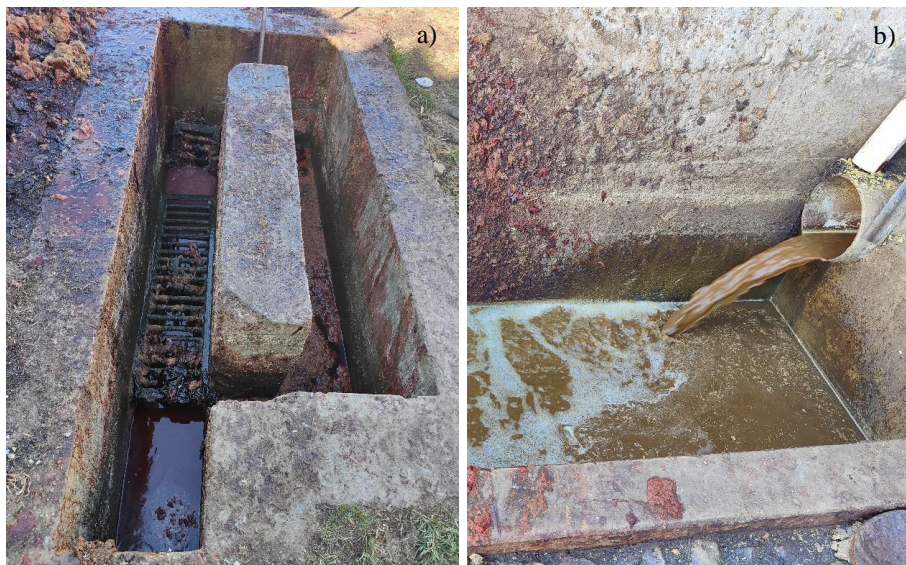
Figura 3.2. Descargas del matadero municipal, a) descarga desde la sala de oreo, b) descarga desde el faenado y despiece. Fuente: Fotografía tomada por el autor.
