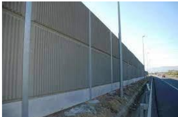
Figura 5: Pantalla acústica de hormigón. Fuente: (INSAMETAL, S.A, 2022).
