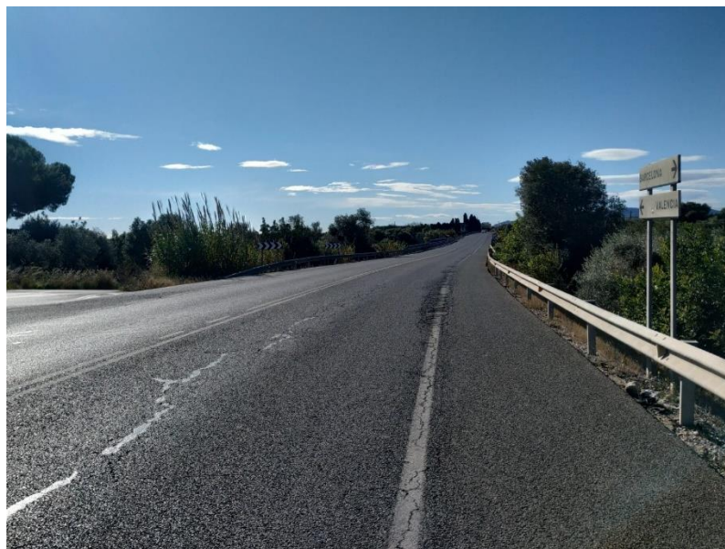
Imagen 2. Estado actual de la N-340a en el P.K. 1048+200. (Fuente: Elaboración propia)
