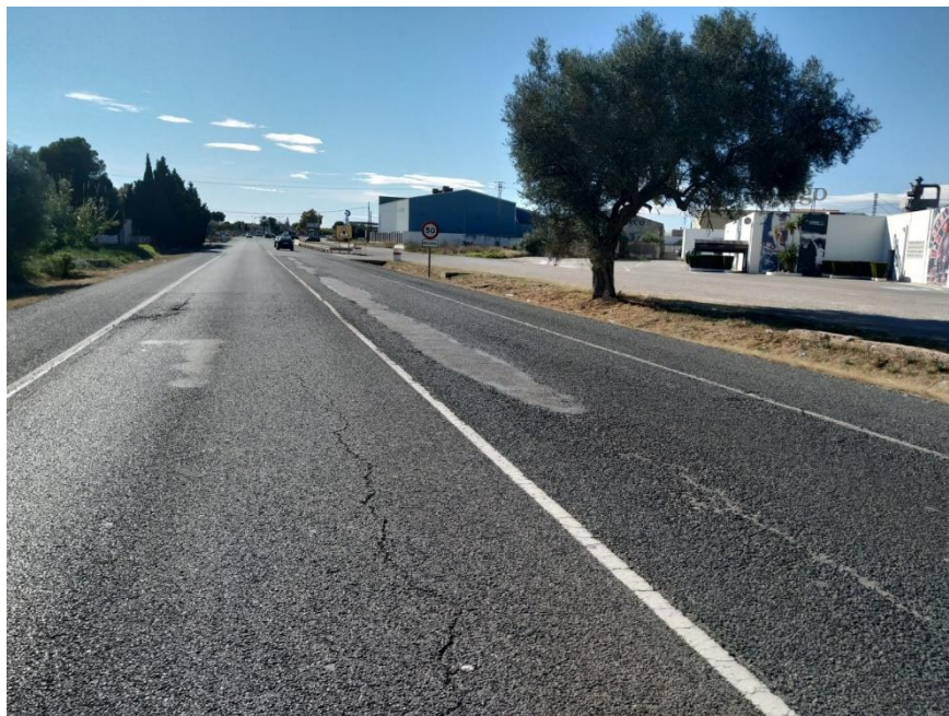
Imagen 1. Estado actual de la N-340a en el P.K. 1050+600. (Fuente: Elaboración propia)
