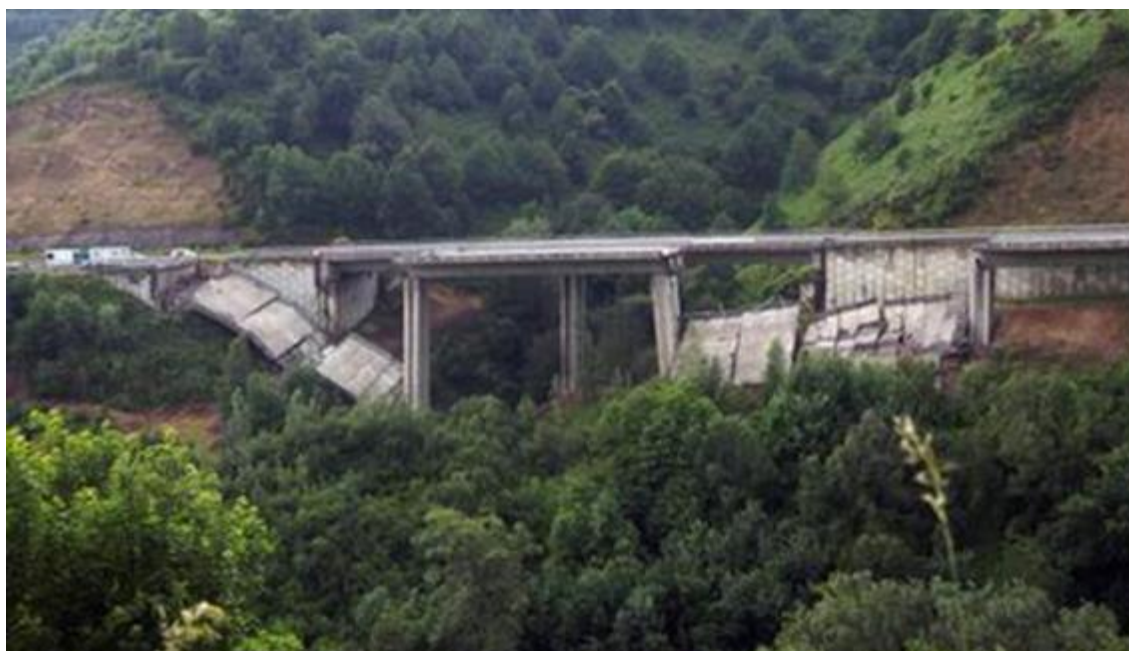
Figura. 9. Viaducto de O Castro en la A-6 tras el segundo derrumbe, Vega de Valcarce, España. (Fuente: www.elpais.com )
