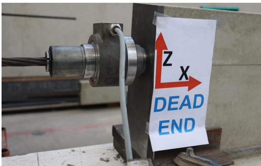
Figura. 87. Estado de la viga tras acuñar la viga, vista del anclaje pasivo. (Fuente: Elaboración propia)
