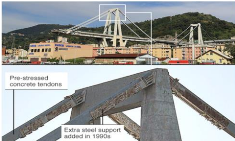
Figura. 8. Detalle de los tendones de hormigón pretensado corroídos. (Fuente: ATP)
