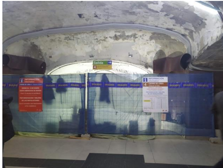
Img nº9. Fotografía de archivo personal. Restauración de mosaico en túnel de metro de Madrid. Capturada una tarde de febrero de 2021
