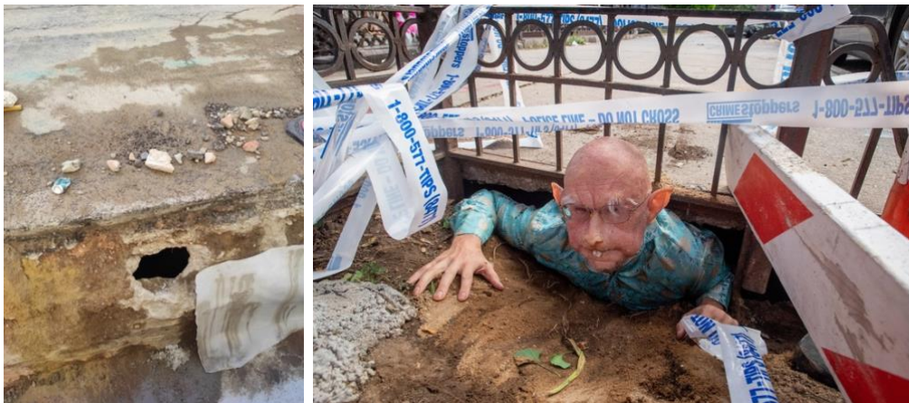
Img nº11 (izquierda). Fotografía de archivo personal. Agujero en medio de la calle, Valencia. Capturada una tarde de mayo de 2023
