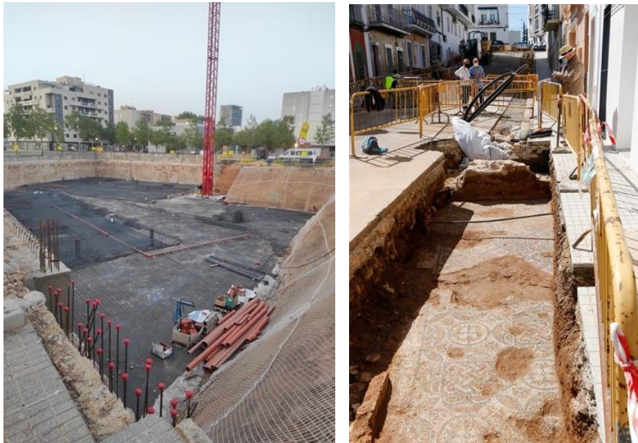
Img nº7 (izquierda). Fotografía de archivo personal. Obra en el barrio de Huerta Rosales, Badajoz. Capturada una tarde de marzo de 2023
