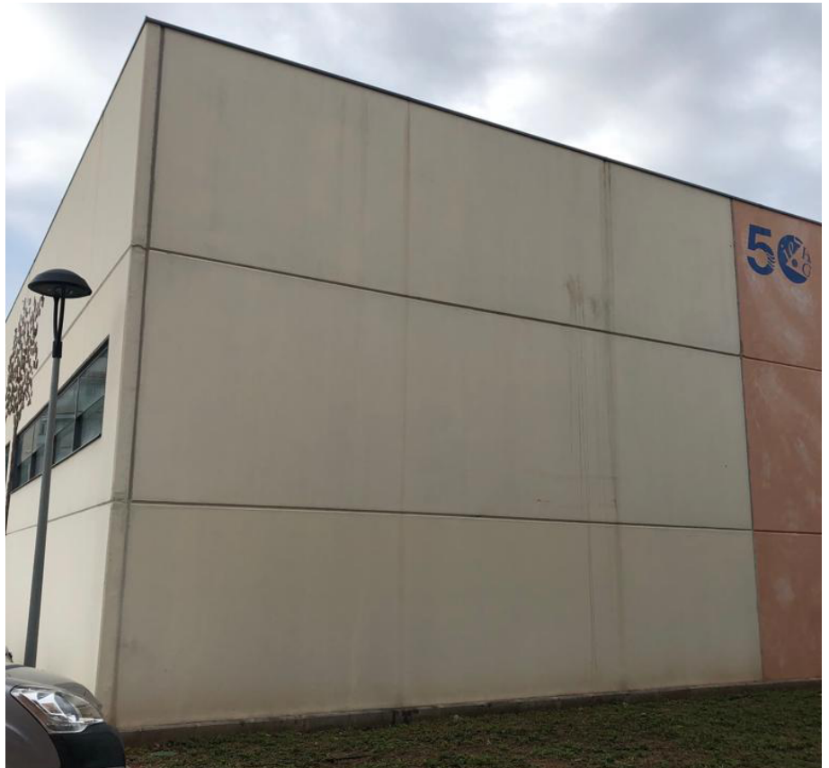
Fig. 40. Estado inicial del muro de la fachada de IES Honori García
