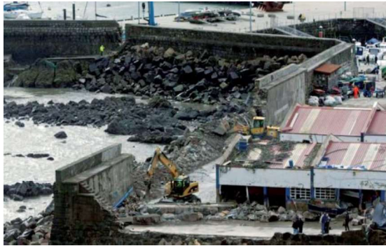
Figura 22. Rotura de la zona de protección y afección a las lonjas. Fuente: Asociación Técnica de Puertos y Costas
