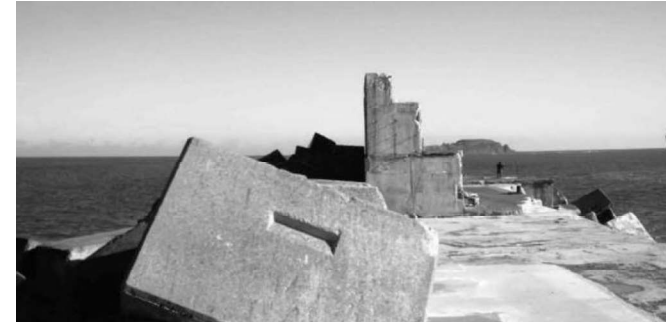
Figura 21. Rotura del espaldón en temporal del 2007. Fuente: Comité Técnico de Ingeniería Portuaria de la Asociación Técnica de Puertos y Costas
