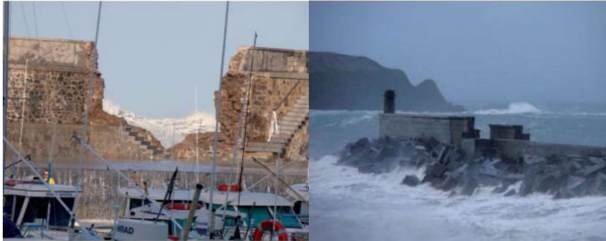
Figura 23. Rotura del espaldón en Tramo 1 y desplazamiento en Tramo 4. Fuente: Asociación Técnica de Puertos y Costas
