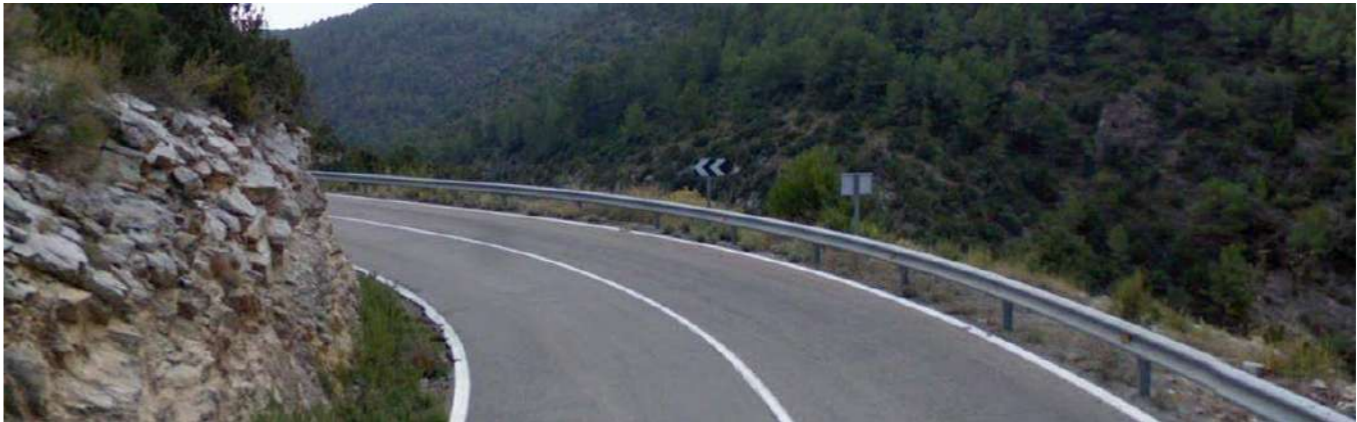
Zona de baja visibilidad (Sentido decreciente)
