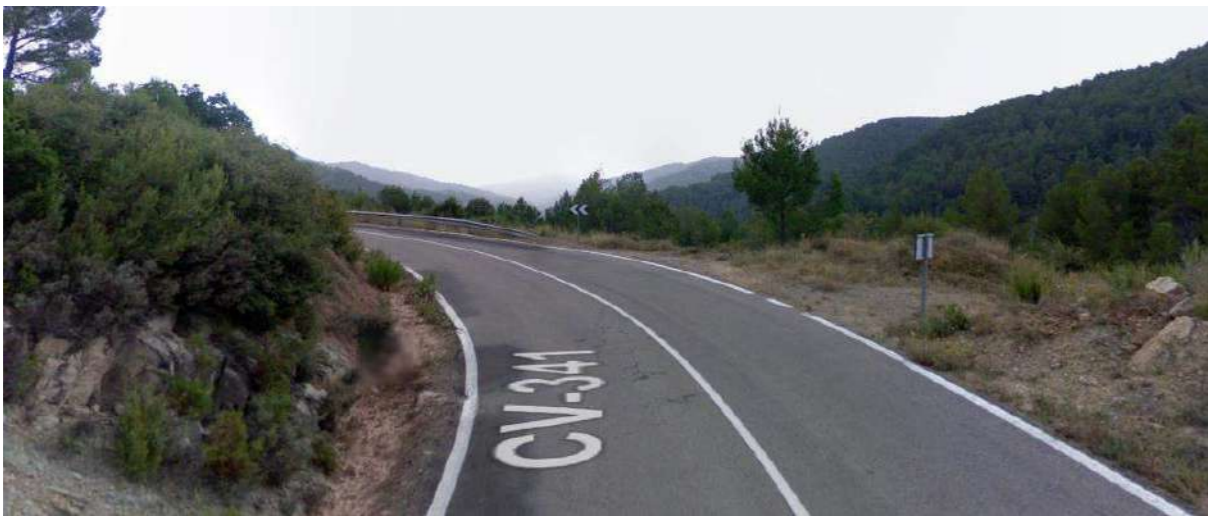
Zona de baja visibilidad (Sentido decreciente)
