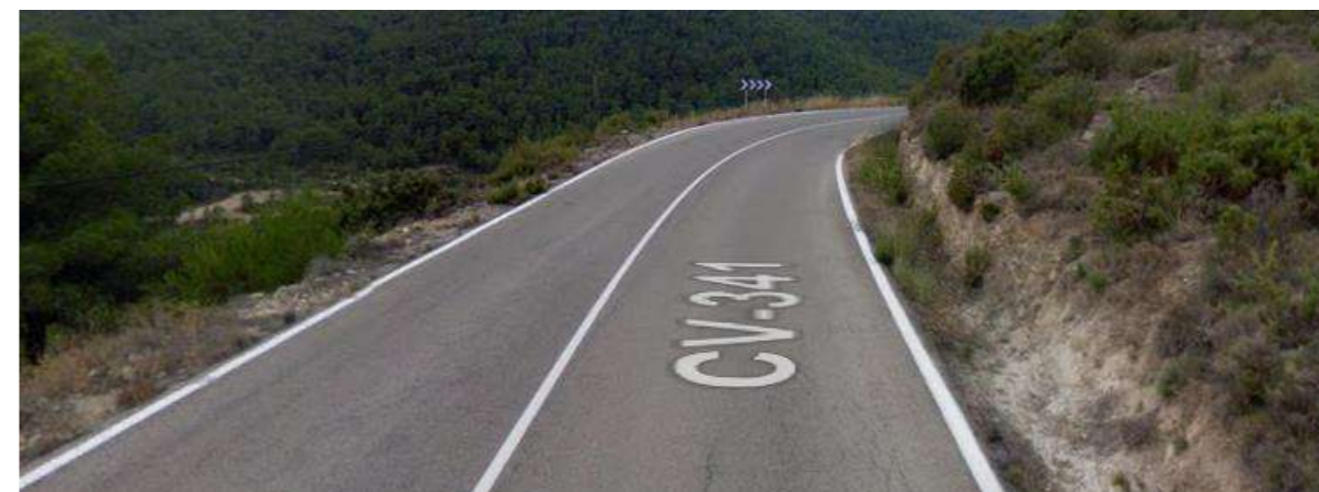
Imagen 17: Trazado sin drenaje longitudinal. Fuente: Google Earth
