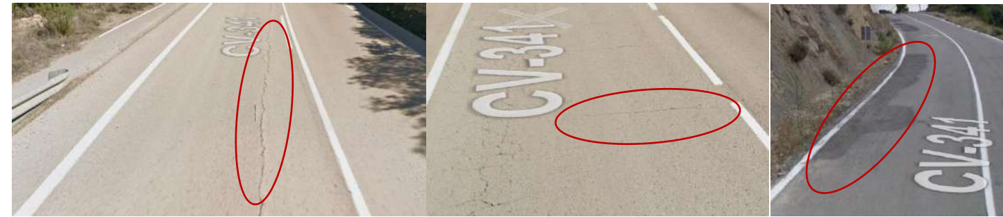
Imagen 10: Grietas longitudinales, transversales y parches de asfalto Fuente: Elaboración propia a partir de visor GVA
