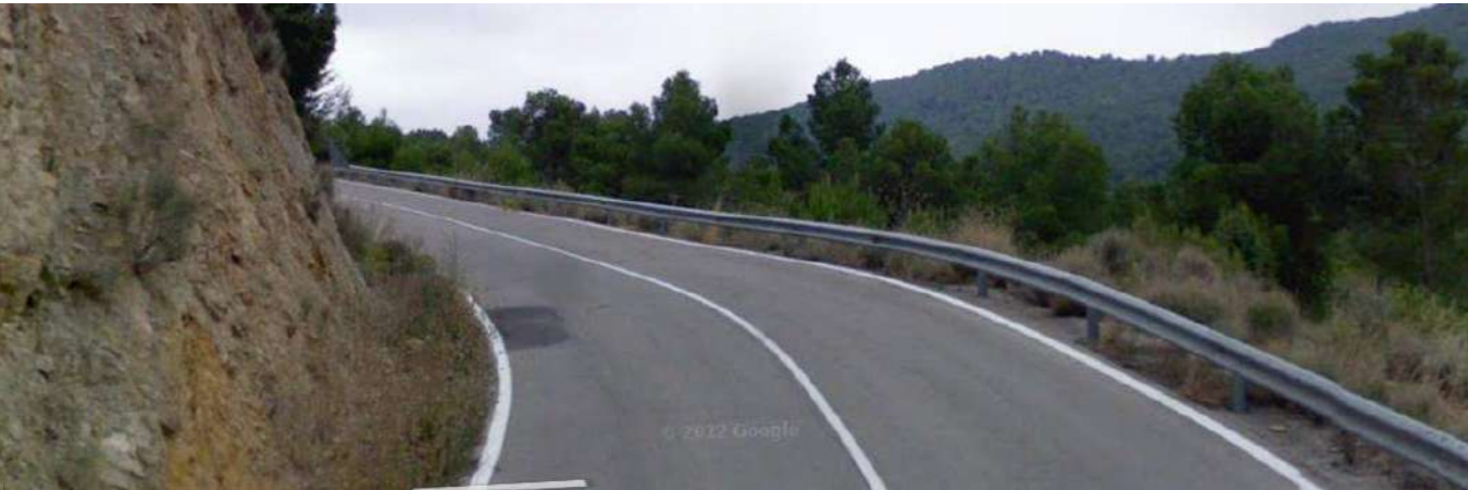
Zona de baja visibilidad (Sentido decreciente)
