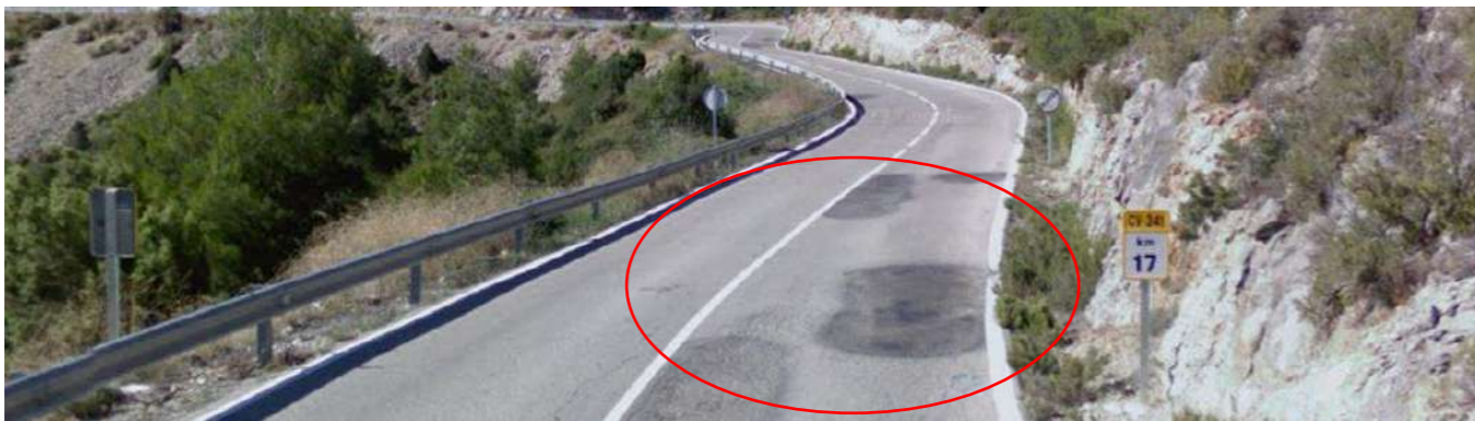
Imagen 17: Deficiencias presentadas en el asfalto del tramo 2 Fuente: Elaboración propia
