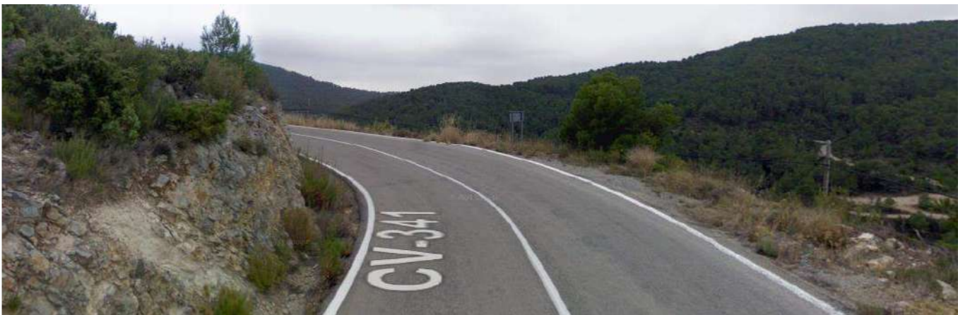
Zona de baja visibilidad (Sentido decreciente)
