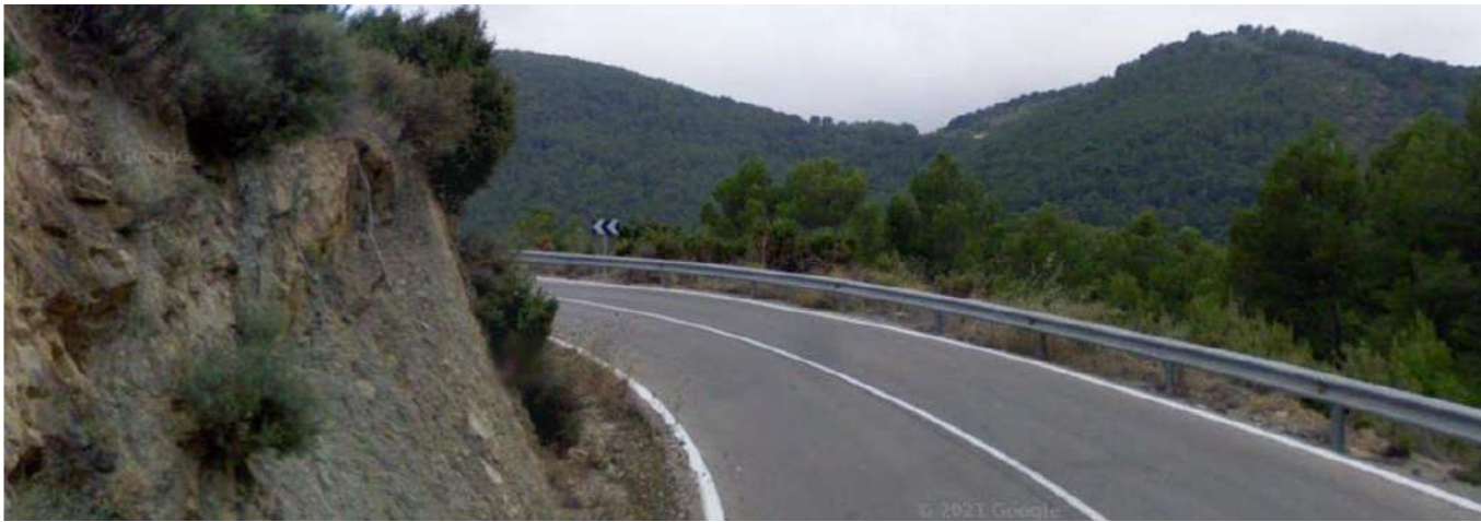
Zona de baja visibilidad (Sentido decreciente)
