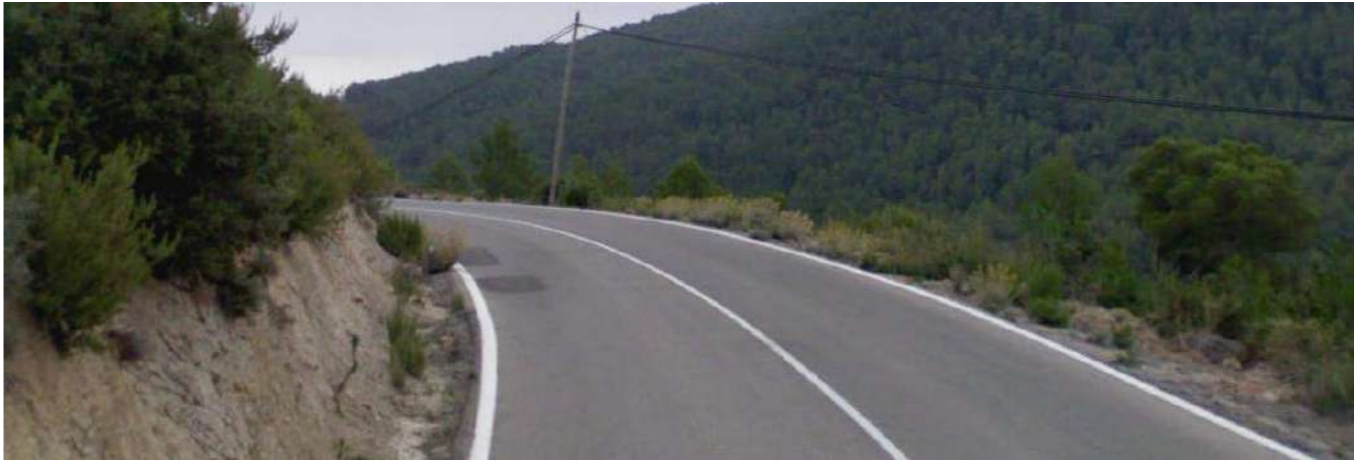
Zona de baja visibilidad (Sentido decreciente)
