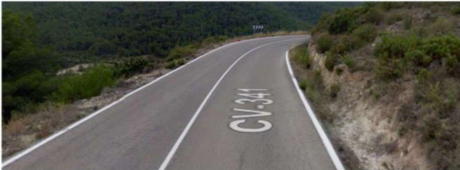
Imagen 11: Trazado sin drenaje longitudinal. Fuente: Google Earth
