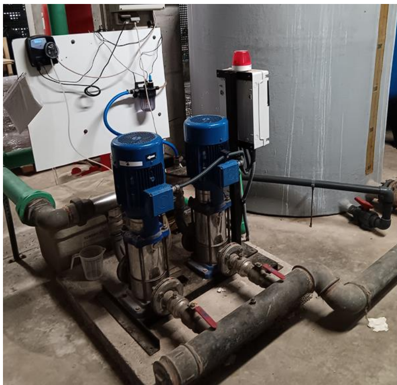
Figura 11 . Bombeo hacia el vaso grande mediante 2 bombas en paralelo
