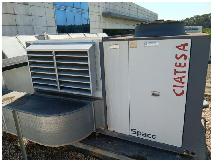
Figura 4. Unidad compacta o Rooftop
