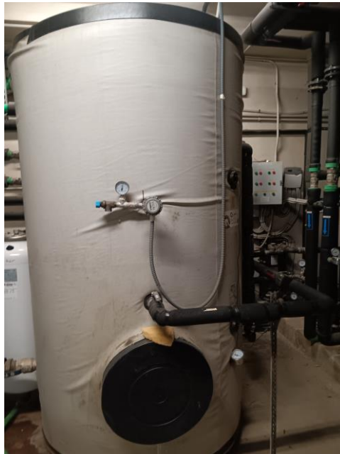
Figura 10. Depósito de ACS
