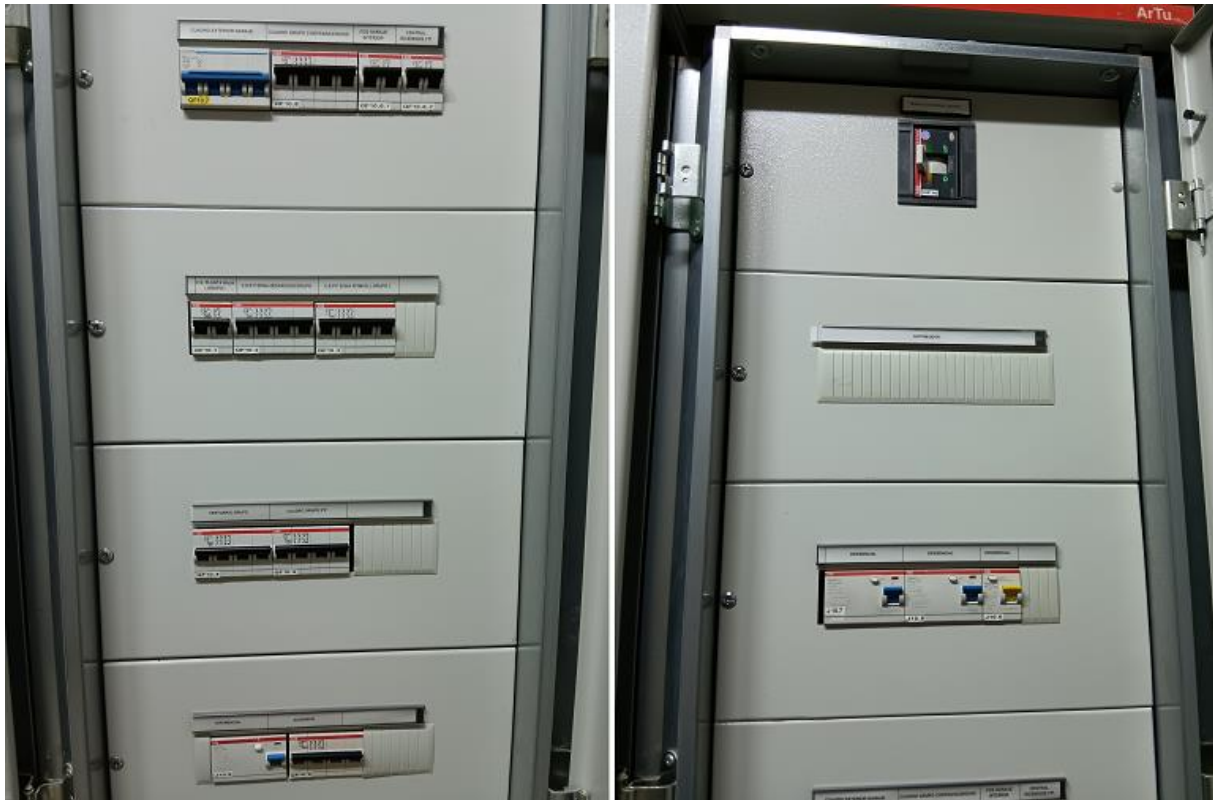
Figura 13. Detalle del armario eléctrico con el cuadro eléctrico general
