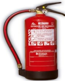
Figura 3. Equipo contra incendios extintor.
