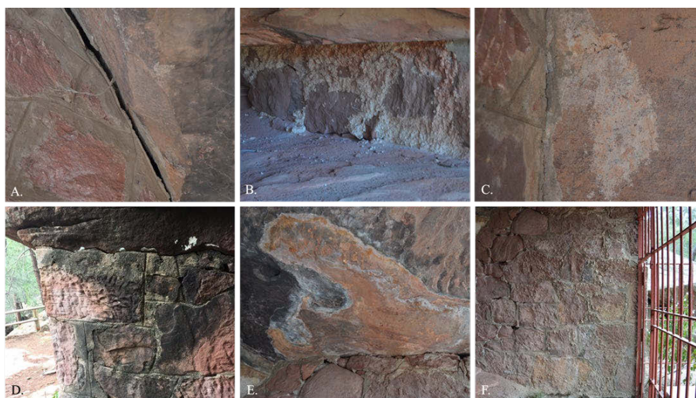
Fig. 2 Indicadores de alteración de Los Toros del Prado del Navazo . A) Mortero de rejunte; B) Eflorescencias salinas; C) Invasión de mortero; D) Registro de canalización de agua y biopátina; E) Infiltración de agua y eflorescencias salinas; F) Eflorescencias salinas
