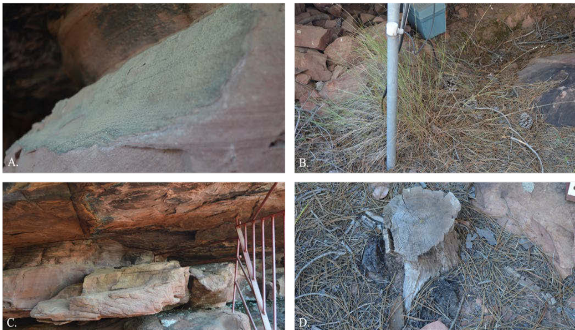
Fig. 5 Indicadores de alteración de Cabras Blancas . A) Acumulación de sustancias detríticas; B) Presencia de arbustos; C) Prolongación del cerramiento hasta el soporte; D) Acumulación de material combustible
