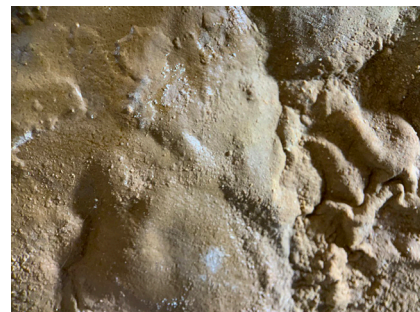
Fig. 56. Detalle de los abolsamientos provocados por las sales.
