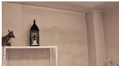
Fig. 41. Estado de las paredes del inmueble.
