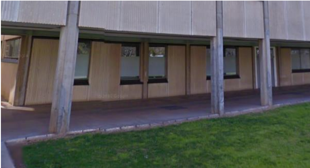
Img. 67: Pilares 39, 40 y 41 de planta baja del edificio de acceso a la ETSA. Autor: Google Maps
