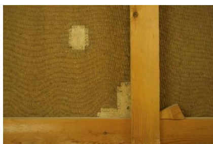
Figura 19. Acumulación de suciedad y parches de intervenciones anteriores.
