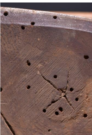
Figura 58: Detalle del ataque causado por la carcoma.
