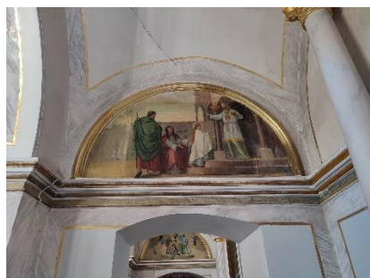
Ilustración 31: Grieta sobre la pintura de la Presentación de la Virgen en el templo
