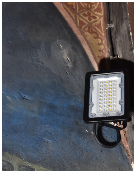
Fig. 37. Faltante y mancha generada por mal praxis en la escena 3.
