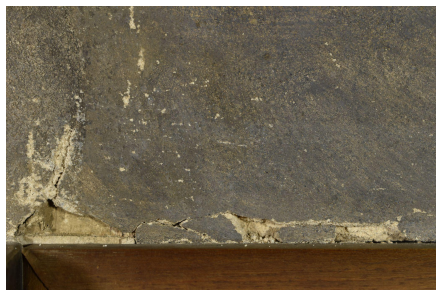
Fig. 36. Detalle del desprendimiento en la zona inferior de la tercera escena.
