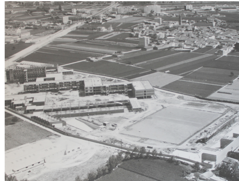
Construcción de las Escuelas Profesionales de San José con el barrio de Campanar de fondo.
