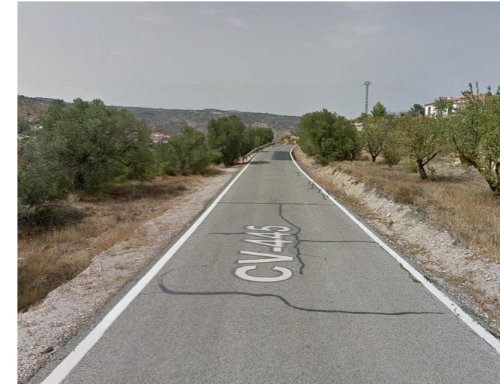
Figura 5. Grietas en el pavimento. Fuente: Google Maps.
