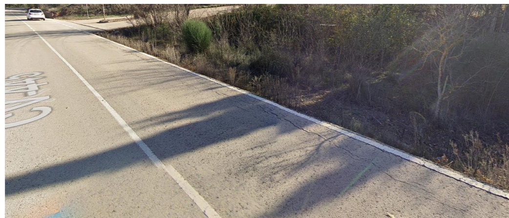
Figura 11. Fisuras en el pavimento Fuente: Google Maps.
