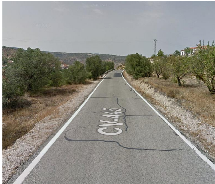
Figura 7. Grietas en el pavimento. Fuente: Google Maps.
