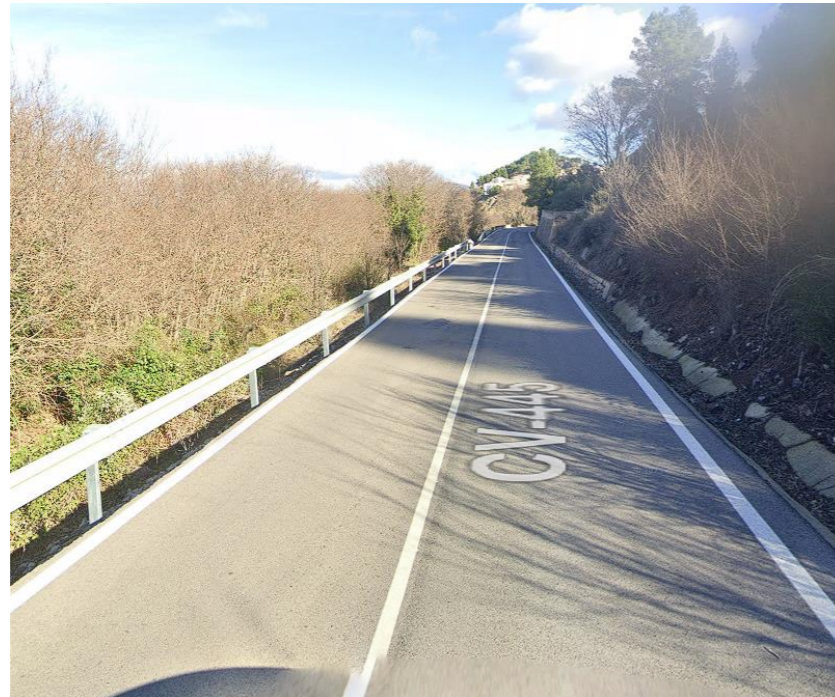
Figura 10. Estado del pavimento. Fuente: Google Maps.
