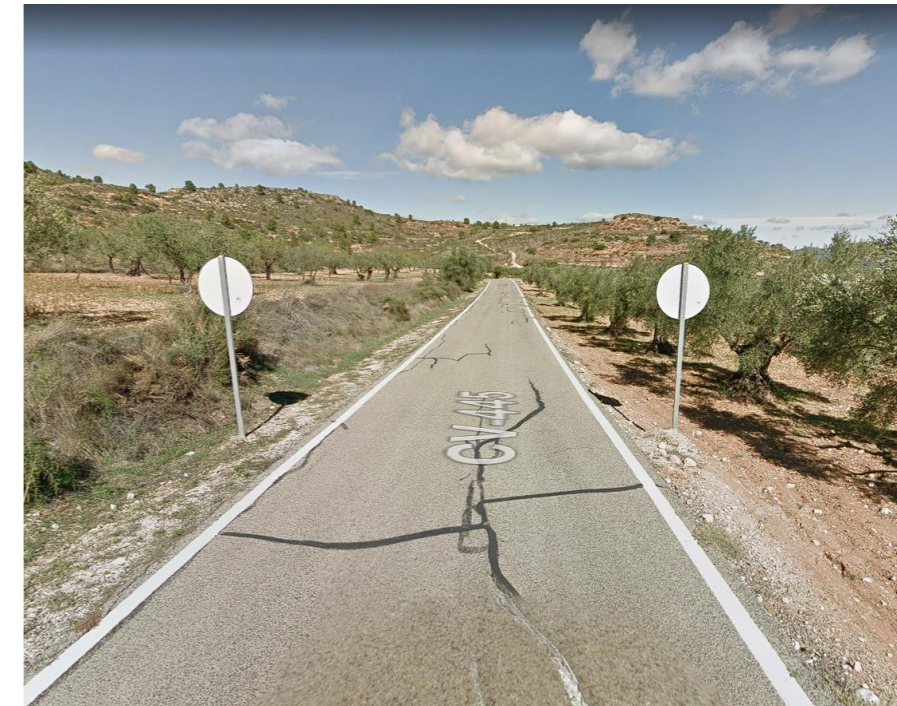
Figura 8. Arcén en mal estado no utilizable. Fuente: Google Maps.
