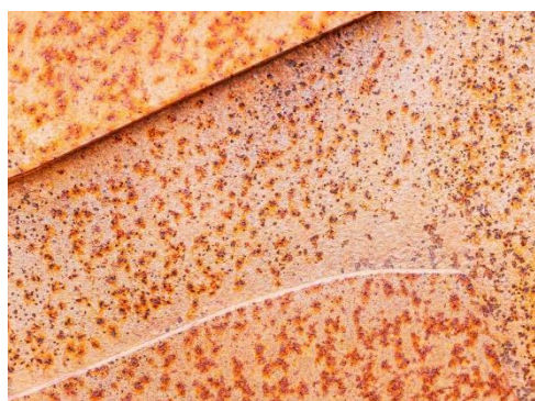
Fig. 7.7. Aspecto corrosión bacteriana o corrosión microbiológica, extraído de Grupo Beta.
