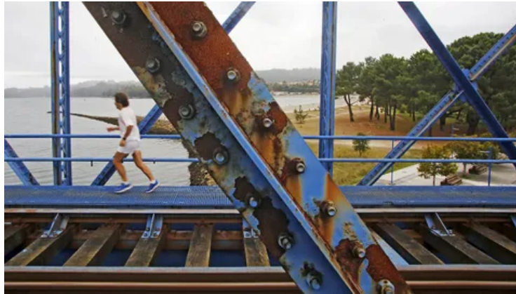
Imagen 51: Puente con corrosión ( www.lavozdeg Galicia.es )
