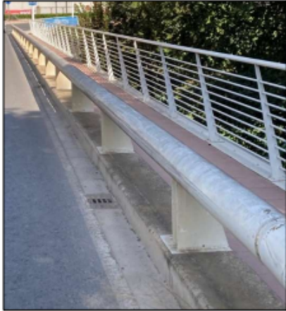
Fotografía 7, Golpes prolongados en pretil
