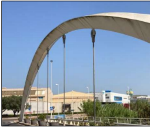
Fotografía 18, Corrosión del arco
