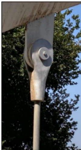
Fotografía 11, Corrosión en péndolas
