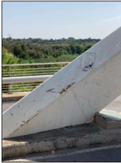
Fotografía 13, Golpes y corrosión en el arranque del arco
