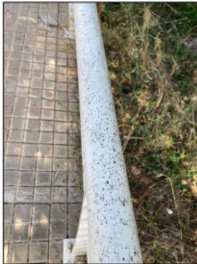
Fotografía 3, Deterioro pasamanos barandillas
