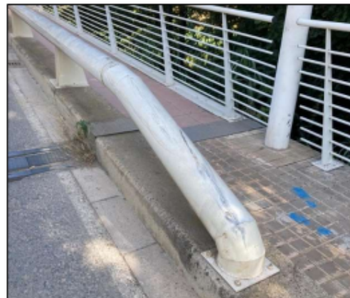
Fotografía 6, Golpes en pretilos
