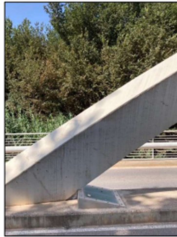
Fotografía 17, Salpicaduras y corrosión del arco
