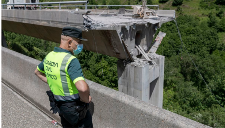
Cae parte de un viaducto en obras de la A-6, entre León y Pedrafita (Lugo). (EFE/Eliseo Trigo)
