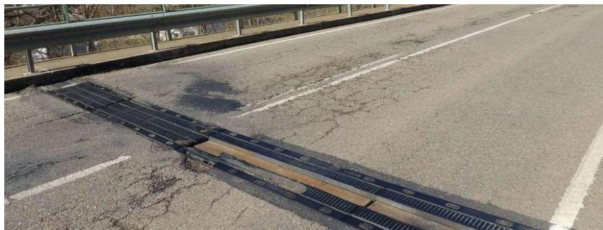
Imagen 20: Detalle del deterioro de la junta de dilatación de un puente ( www.laopiniondezamora.es )
