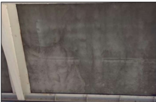
Fotografía 27, Humedades en prelasas
