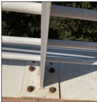
Fotografía 5, Corrosión anclajes barandilla
