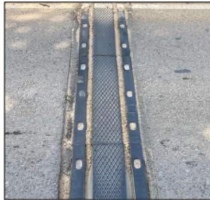
Fotografía 15, Obstrucción juntas de dilatación
