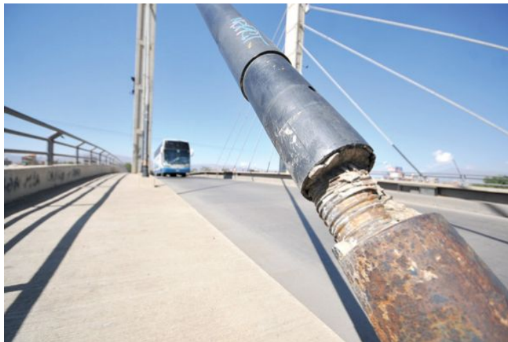
Imagen 53: Tirante deteriorado ( caminosdebolivia.blogspot.com )
