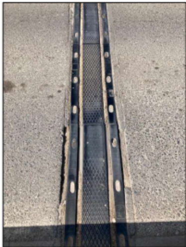
Fotografía 14, Deterioro juntas de dilatación
