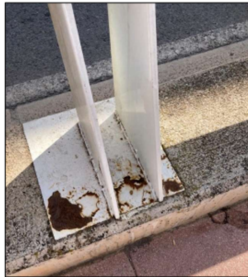
Fotografía 10, Corrosión en pretil
