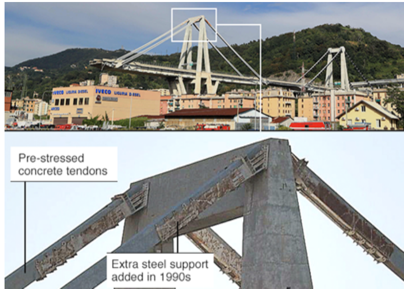
Imagen 26: Detalle del deterioro ( www.idvia.es )
