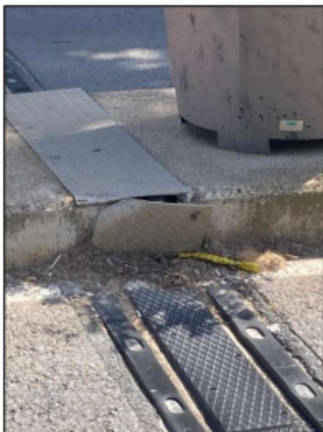
Fotografía 16, Deterioro juntas de dilatación
