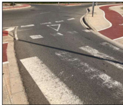
Fotografía 12, Degradación señalización horizontal
