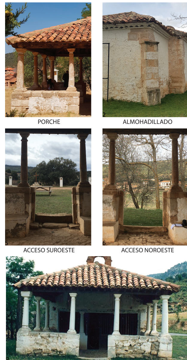
Figura 17: Estado de la ermita antes de una posible intervención. Fuente: Inventario General del Patrimonio de GVA.
