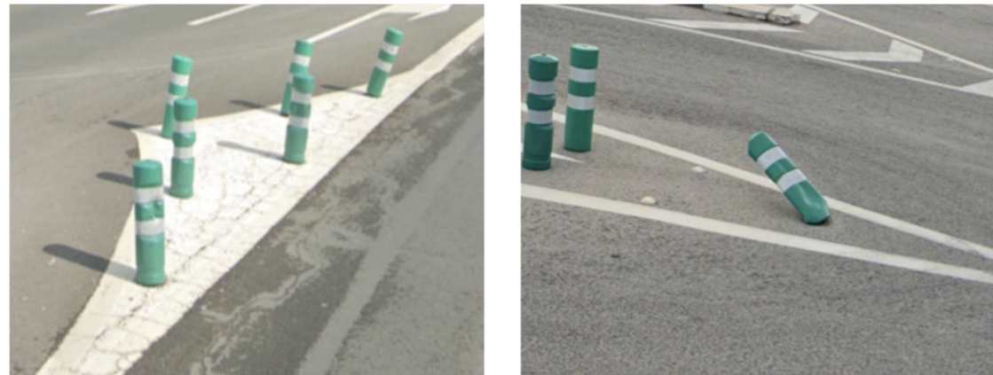
Figura 5. Balizas CH-75 en el p.k. 172+507 del tramo de estudio (Fuente: Elaboración propia)
