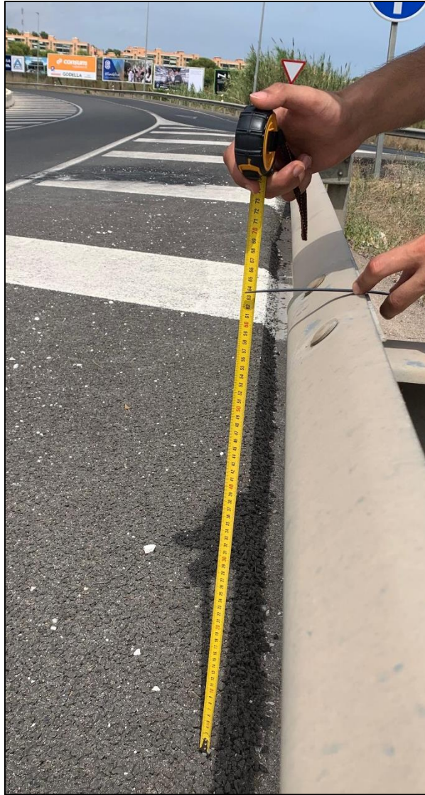
Figura 10. Altura de la barrera metálica en el PK 1+900 ascendente.
