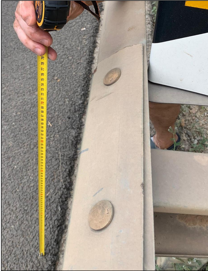
Figura 11. Altura de la barrera metálica en el PK 2+100 ascendente.
