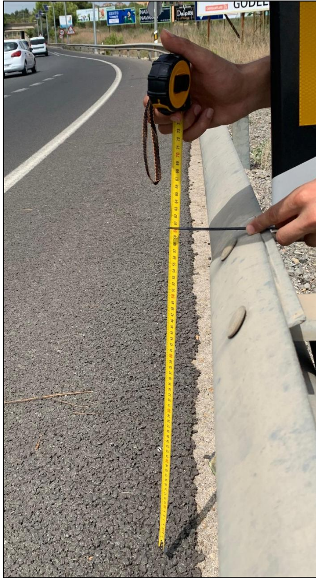
Figura 6. Altura de la barrera metálica en el PK 0+800 ascendente.
