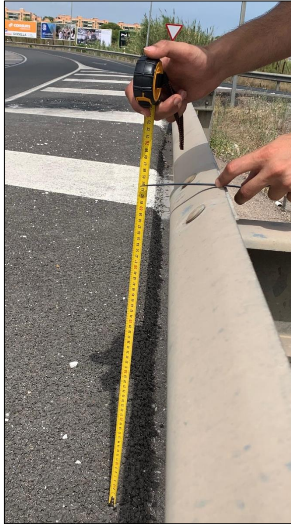
Figura 14. Altura de la barrera metálica en el PK 3+075 ascendente.
