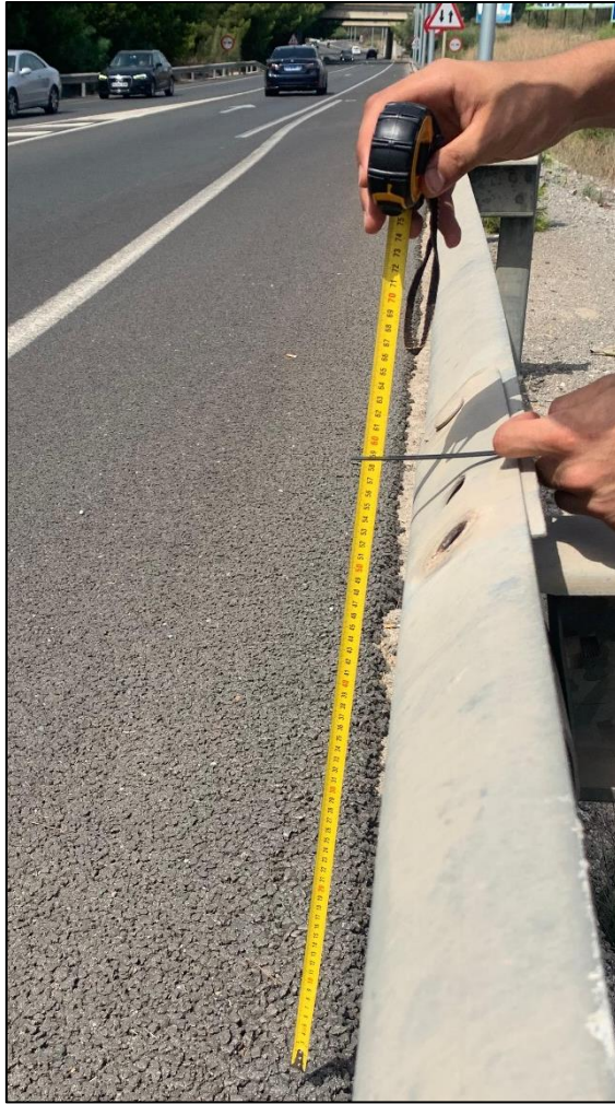
Figura 17. Altura de la barrera metálica en el PK 3+125 ascendente.
