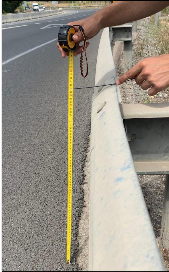
Figura 16. Altura de la barrera metálica en el PK 3+125 ascendente.
