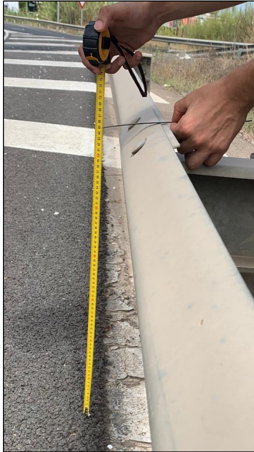
Figura 2. Altura de la barrera metálica en el PK 0+650 ascendente.
