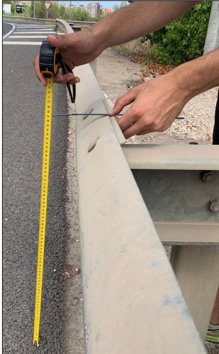
Figura 8. Altura de la barrera metálica en el PK 0+875 ascendente.
