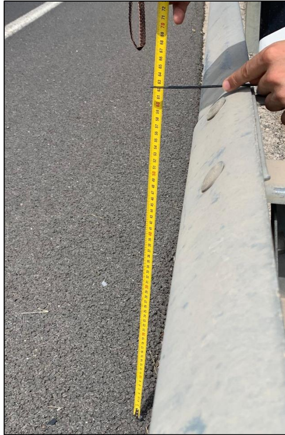
Figura 1. Altura de la barrera metálica en el PK 0+600 ascendente.
