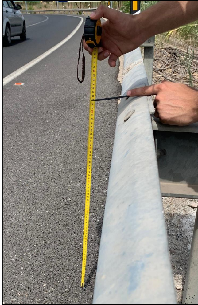
Figura 5. Altura de la barrera metálica en el PK 0+775 ascendente.
