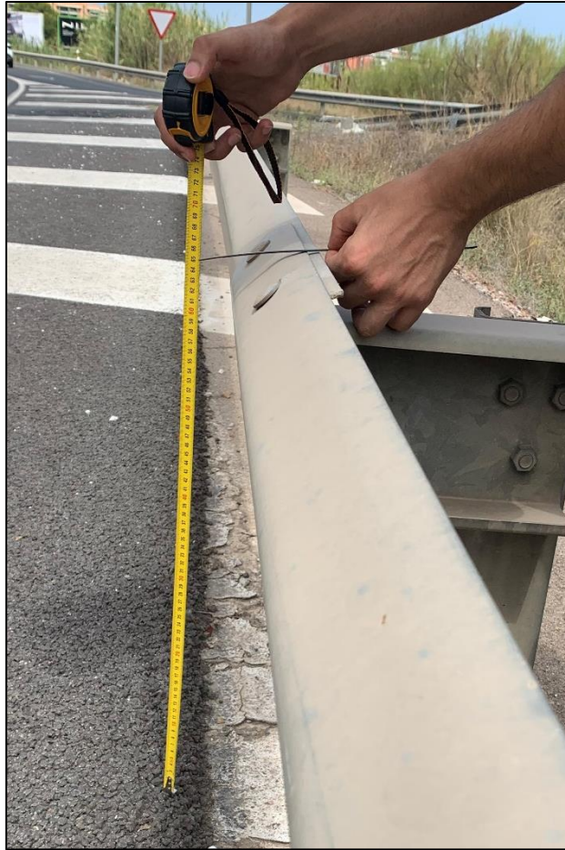
Figura 9. Altura de la barrera metálica en el PK 1+850 ascendente.
