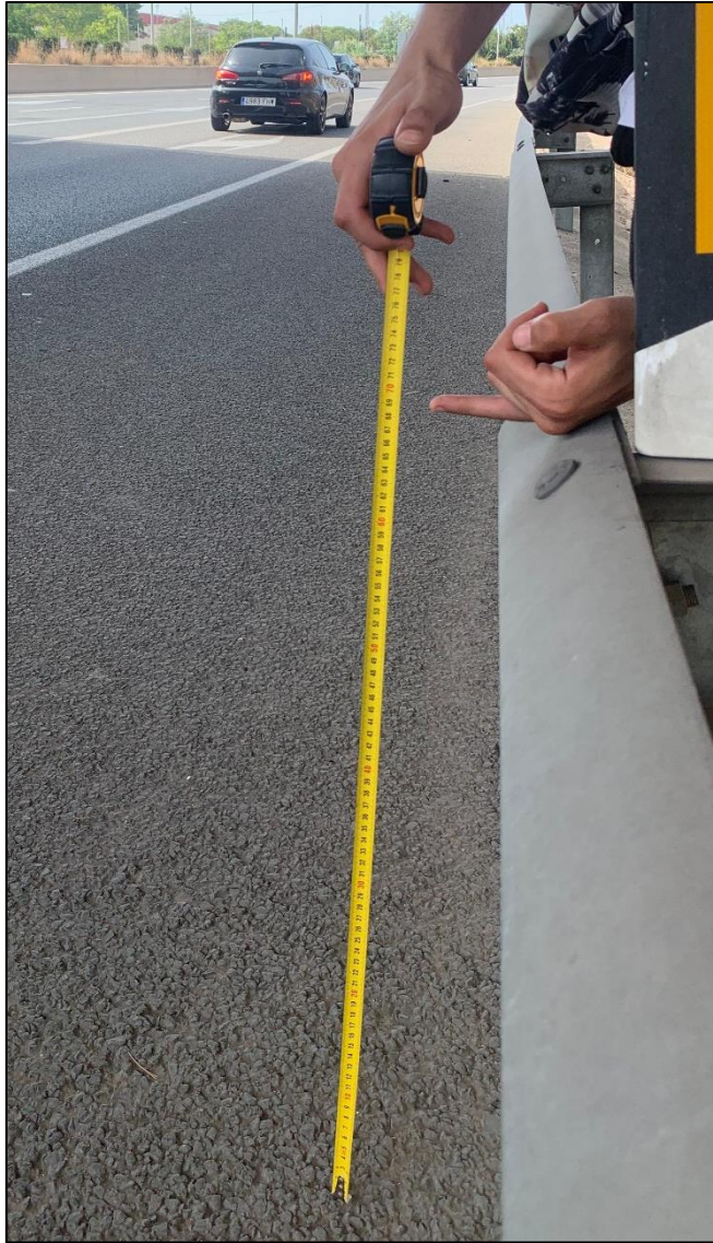
Figura 3. Altura de la barrera metálica en el PK 0+700 ascendente.
