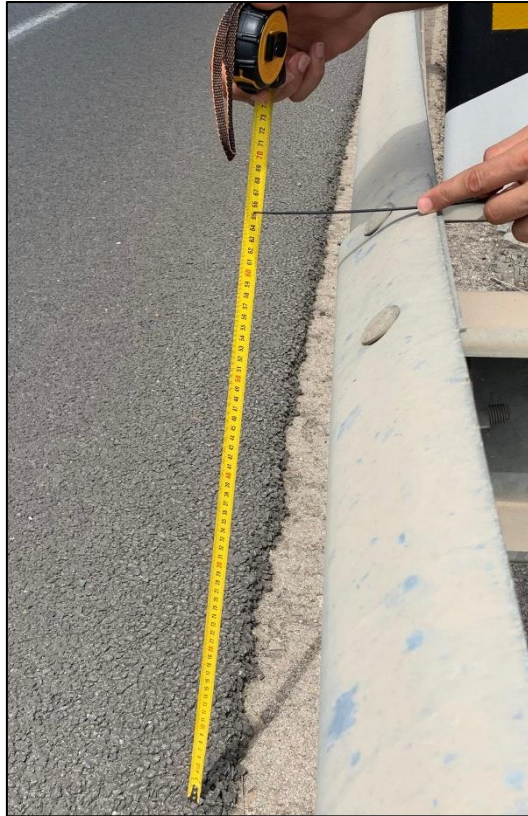
Figura 15. Altura de la barrera metálica en el PK 3+100 ascendente.
