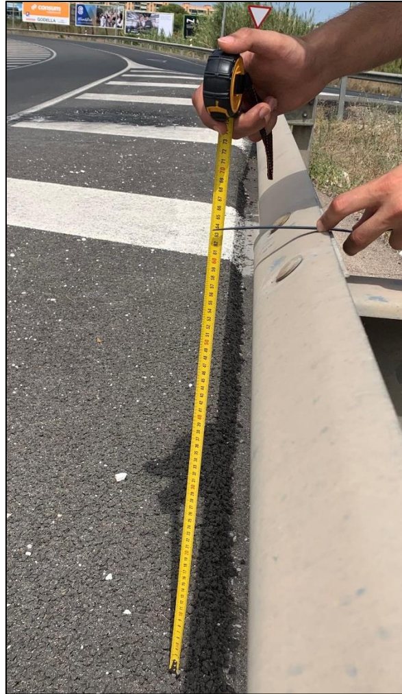
Figura 12. Altura de la barrera metálica en el PK 2+250 ascendente.
