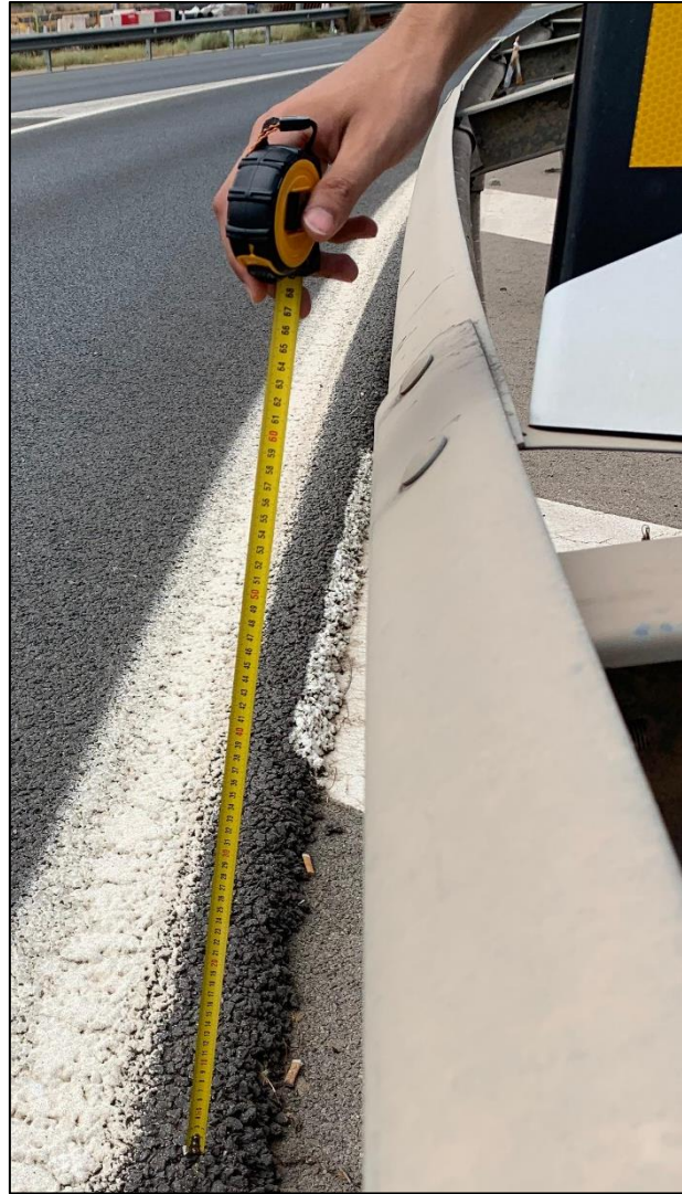
Figura 7. Altura de la barrera metálica en el PK 0+850 ascendente.
