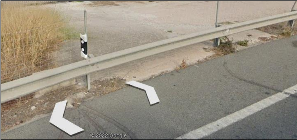
Figura 5. Desnivel entre la rasante de la carretera y la berma
