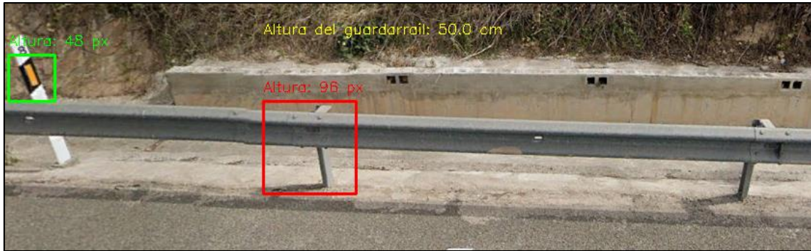
Figura 116. Altura de la barrera metálica insuficiente. PK 0+800 en sentido ascendente
