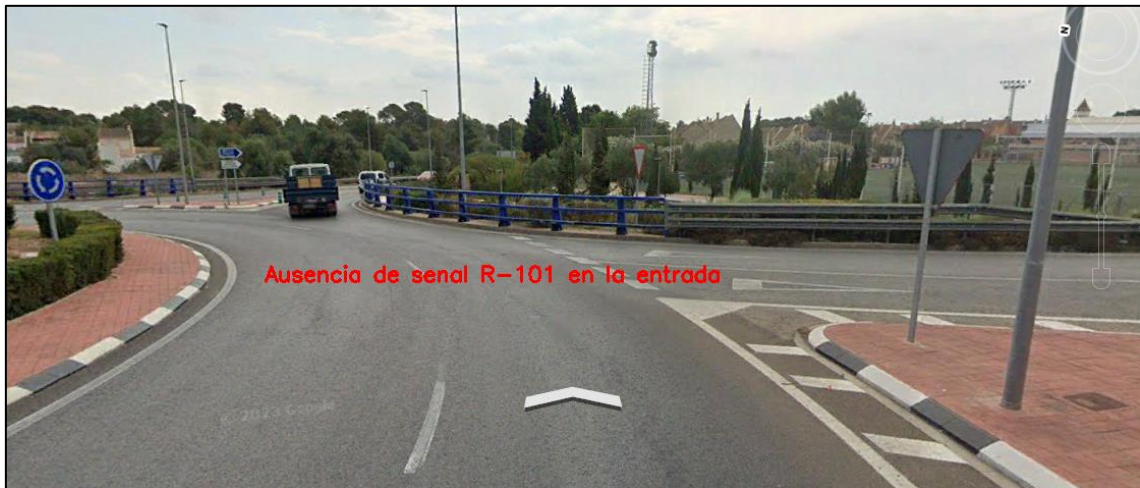
Figura 168. Ausencia de señal R-101 en el carril de entrada S
