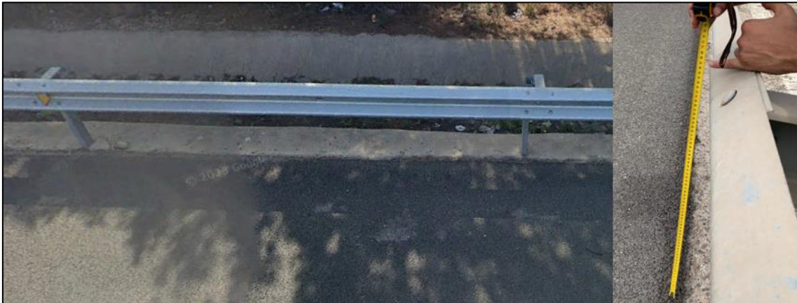
Figura 136. Altura de la barrera metálica insuficiente. PK 3+200 en sentido descendente. (68 cm)
