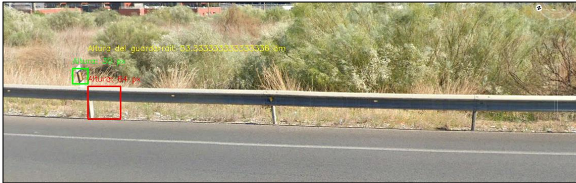
Figura 129. Altura de la barrera metálica insuficiente. PK 3+050 en sentido ascendente.
