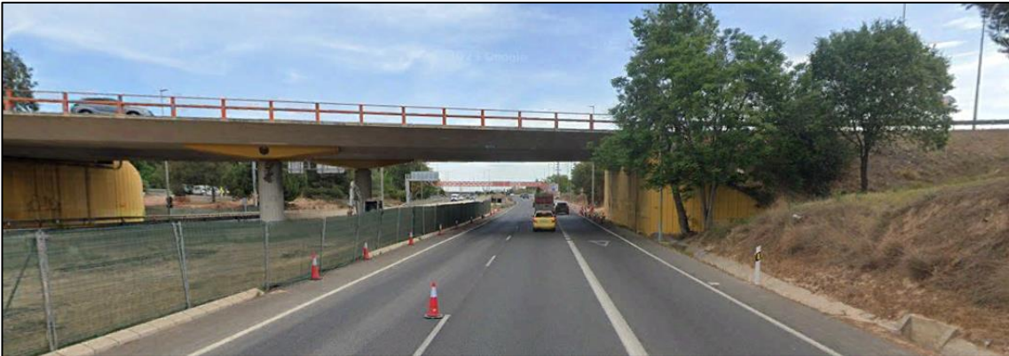
Figura 87. Fotografía de la sección transversal de la carretera en el PK 2+120, sentido descendente
