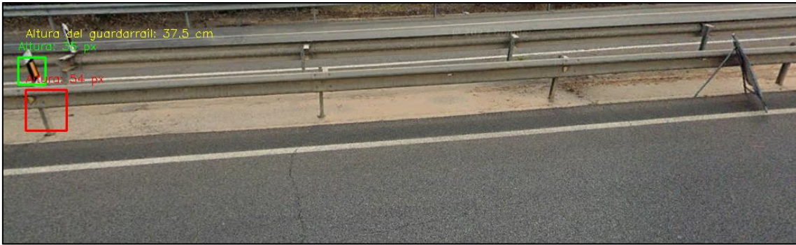
Figura 122. Altura de la barrera metálica insuficiente. PK 1+850 en sentido ascendente.
