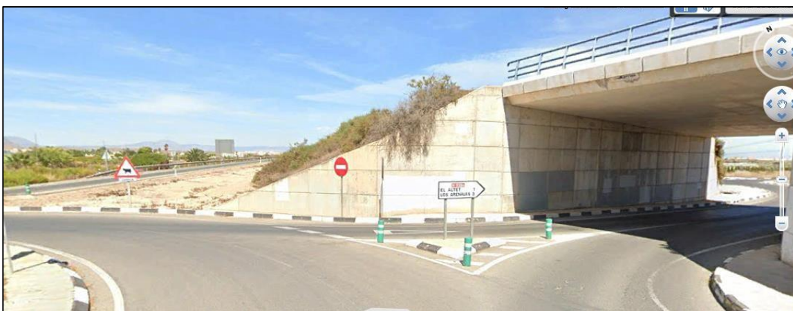
Figura 66. Señal R-101 de entrada prohibida, correctamente colocada en el carril de acceso a la glorieta
