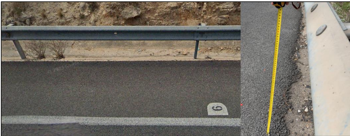
Figura 142. Altura de la barrera metálica insuficiente. PK 2+600 en sentido descendente. (68 cm)
