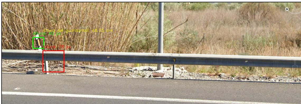
Figura 130. Altura de la barrera metálica insuficiente. PK 3+075 en sentido ascendente.
