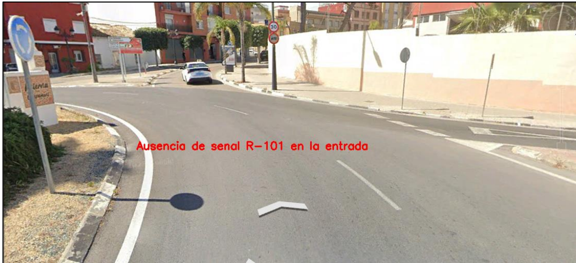
Figura 152. Ausencia de señal R-101 en el carril de entrada NNO
