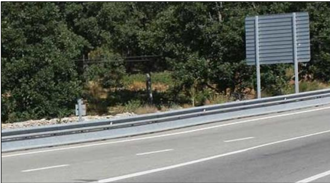
Figura 6. Barrera metálica de altura insuficiente y SPM
