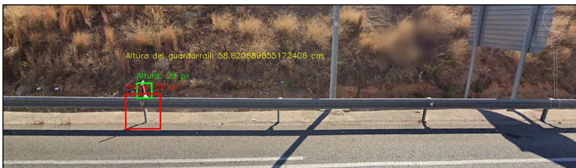
Figura 118. Altura de la barrera metálica insuficiente. PK 0+875 en sentido ascendente
