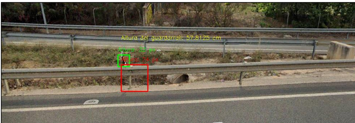
Figura 123. Altura de la barrera metálica insuficiente. PK 1+900 en sentido ascendente.
