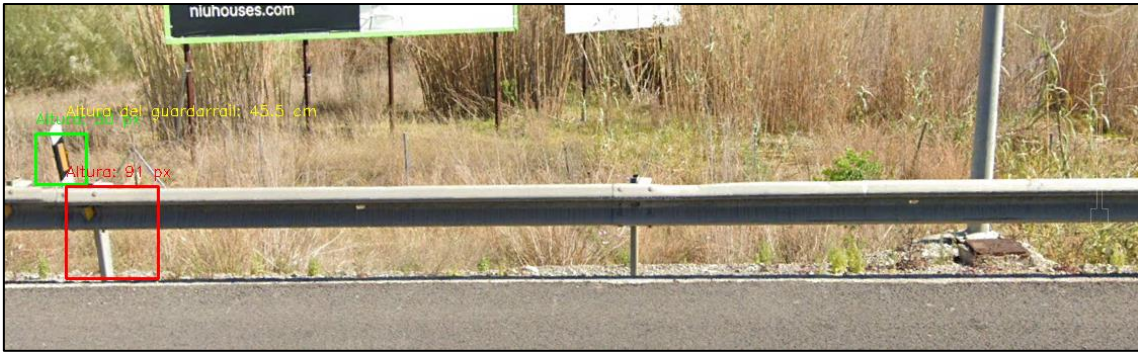
Figura 132. Altura de la barrera metálica insuficiente. PK 3+125 en sentido ascendente.
