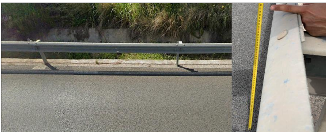
Figura 137. Altura de la barrera metálica insuficiente. PK 3+100 en sentido descendente. (67cm)
