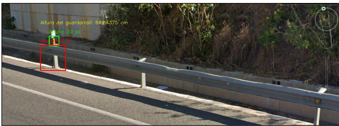
Figura 110. Altura de la barrera metálica insuficiente. PK 0+650 en sentido ascendente
