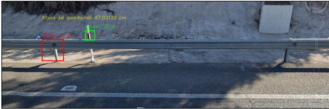
Figura 109. Altura de la barrera metálica insuficiente. PK 0+600 en sentido ascendente.
