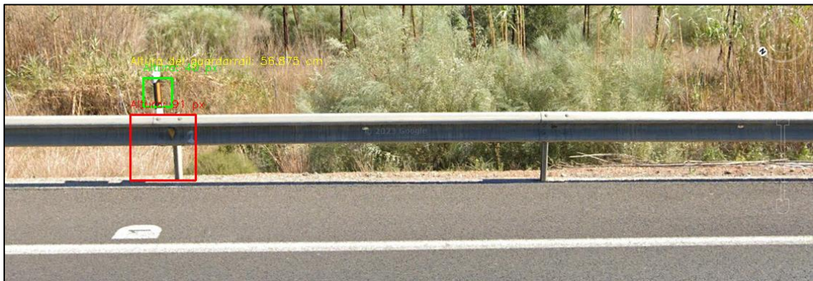
Figura 131. Altura de la barrera metálica insuficiente. PK 3+100 en sentido ascendente.
