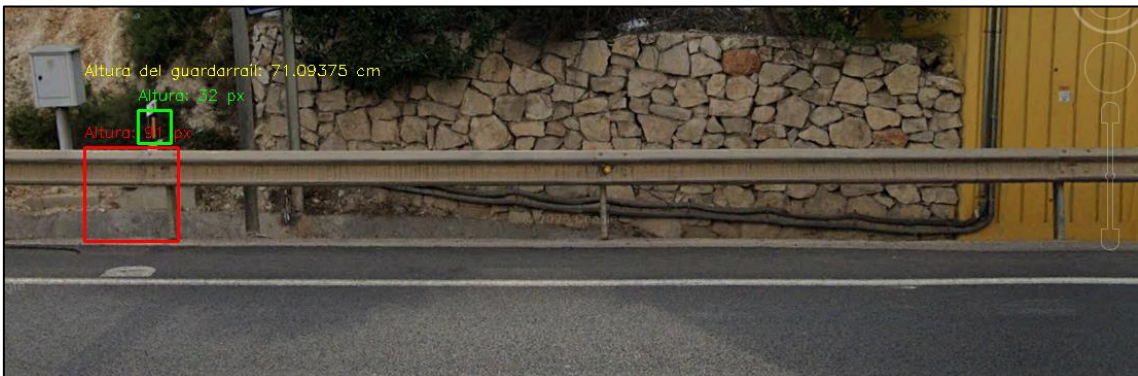
Figura 124. Altura de la barrera metálica insuficiente. PK 2+100 en sentido ascendente.
