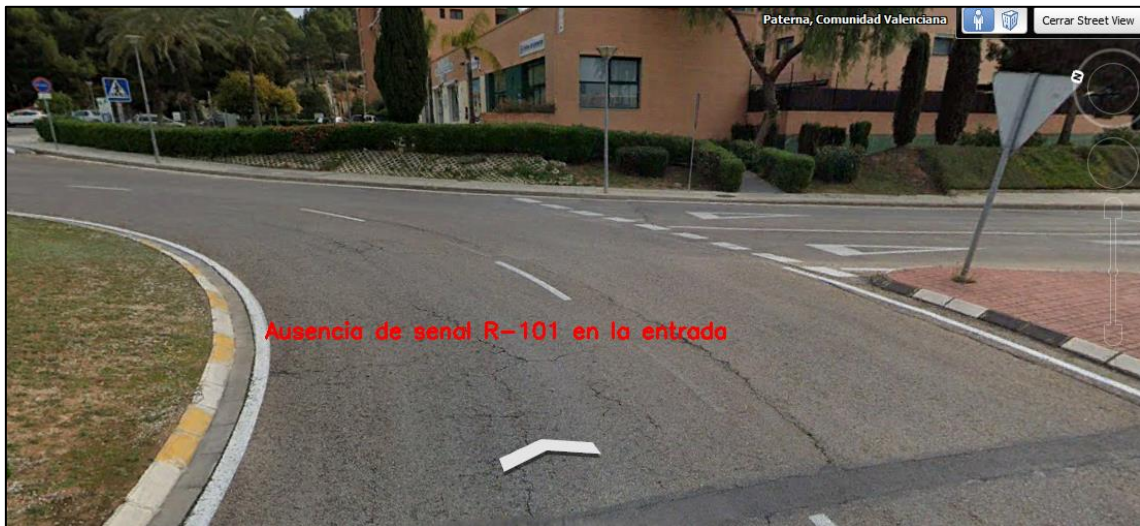
Figura 163. Ausencia de señal R-101 en el carril de entrada SE
