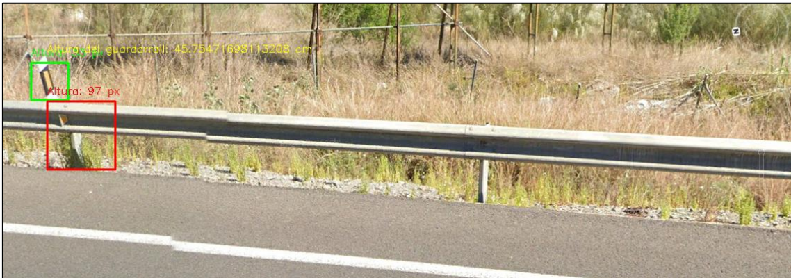
Figura 133. Altura de la barrera metálica insuficiente. PK 3+150 en sentido ascendente.
