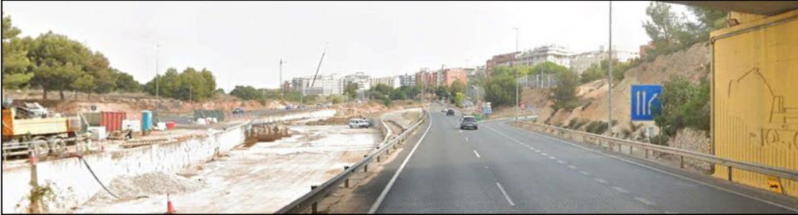
Figura 86. Fotografía de la sección transversal de la carretera en el PK 2+080, sentido ascendente
