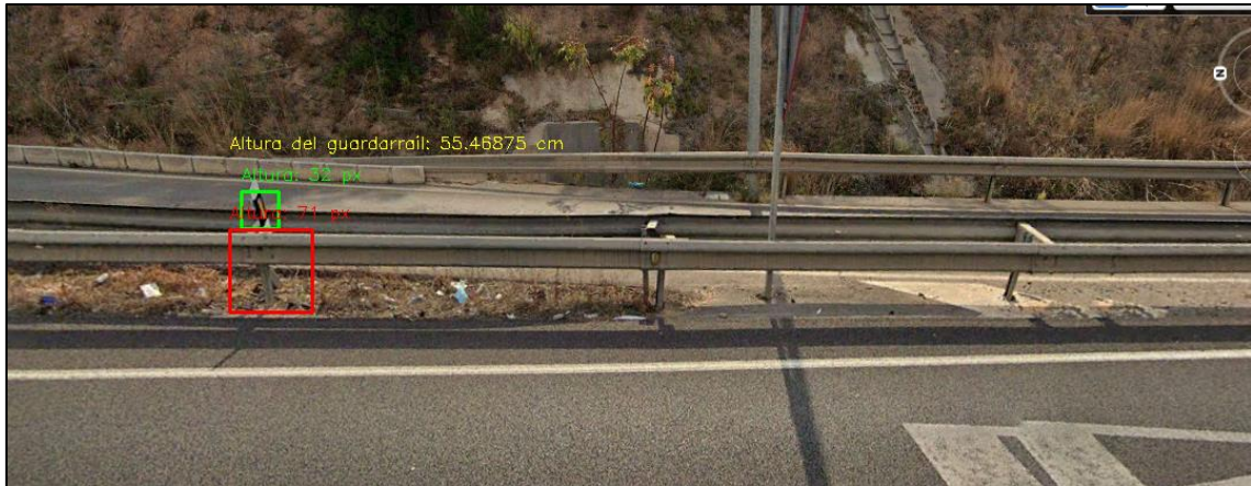
Figura 125. Altura de la barrera metálica insuficiente. PK 2+250 en sentido ascendente.
