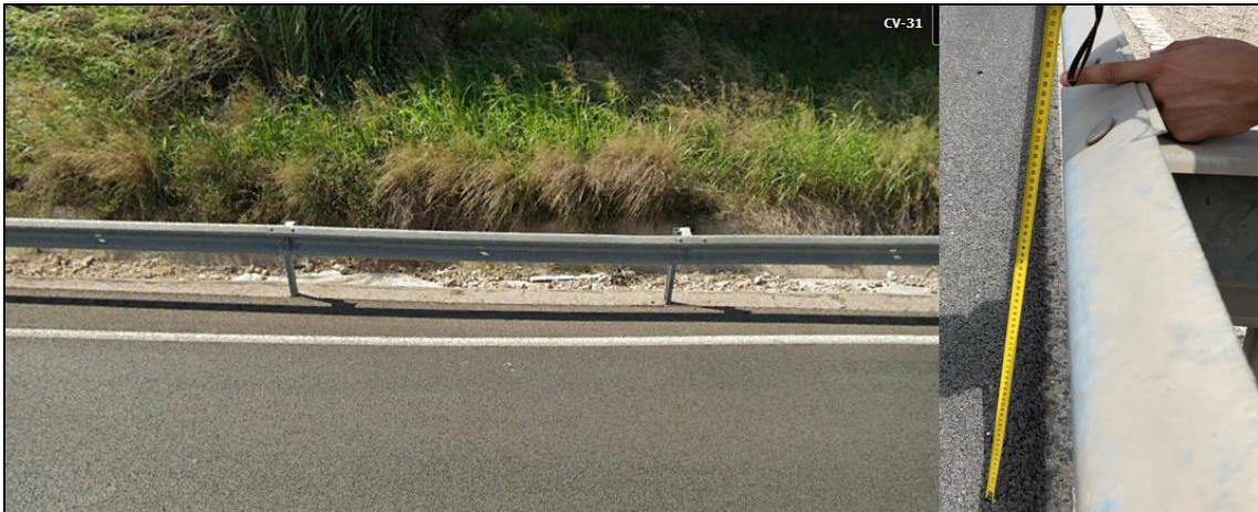
Figura 138. Altura de la barrera metálica insuficiente. PK 3+000 en sentido descendente. (67cm)
