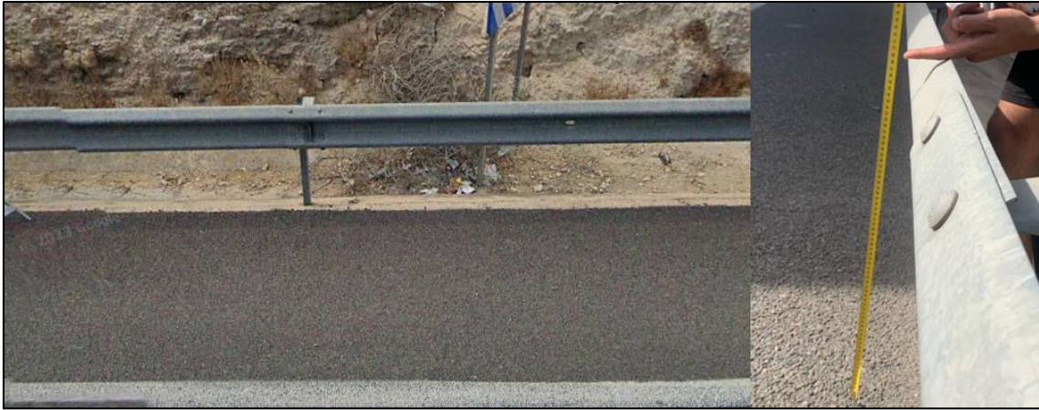
Figura 141. Altura de la barrera metálica insuficiente. PK 2+700 en sentido descendente. (70 cm)
