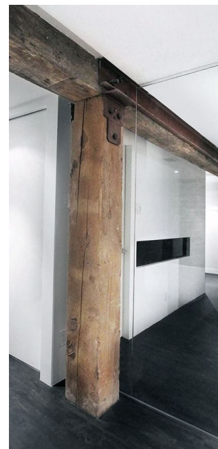
Ilustración 35 - Viga reforzada (Pinterest)
