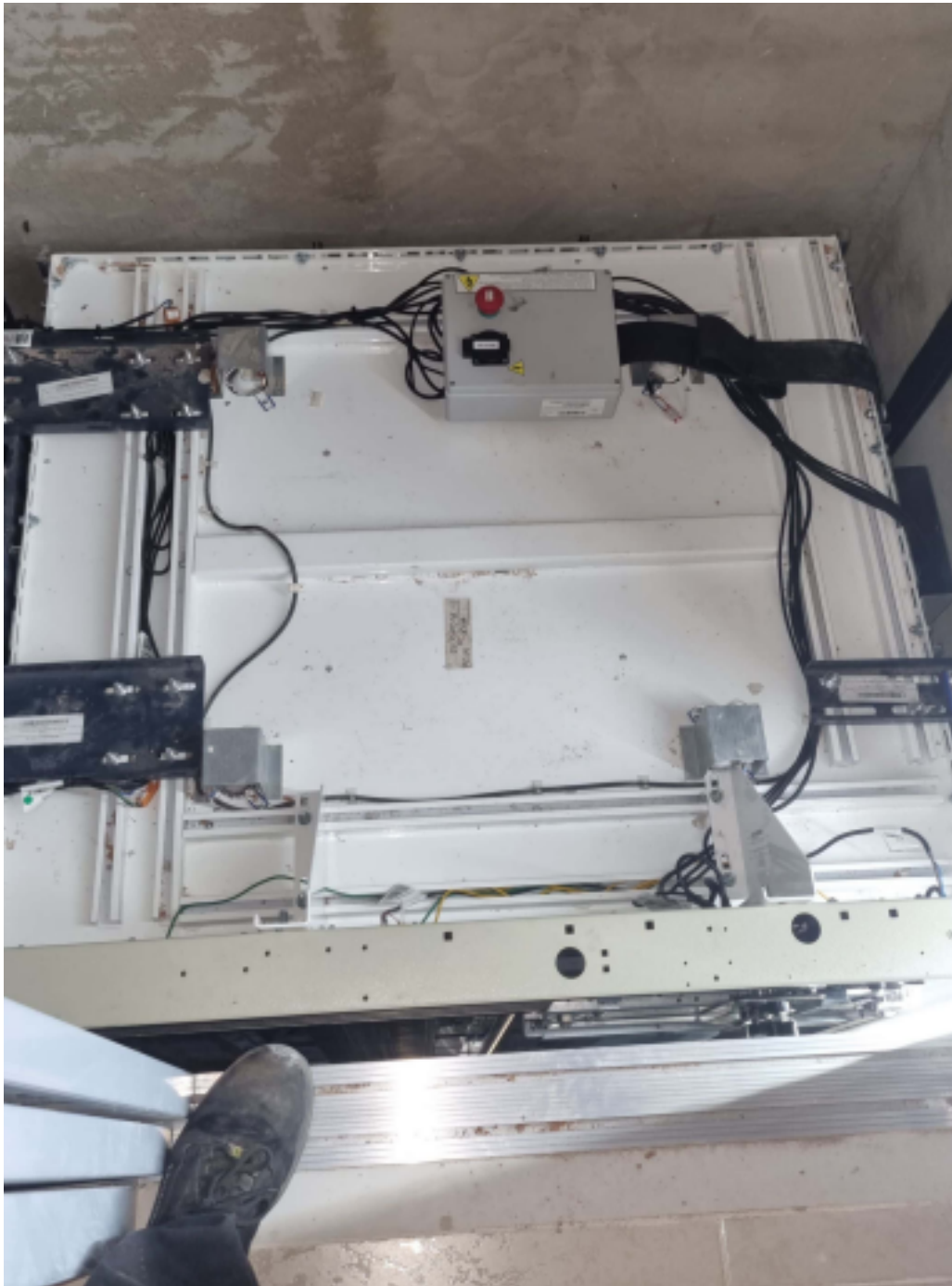
Figura 1.16: Imagen de la instalación
