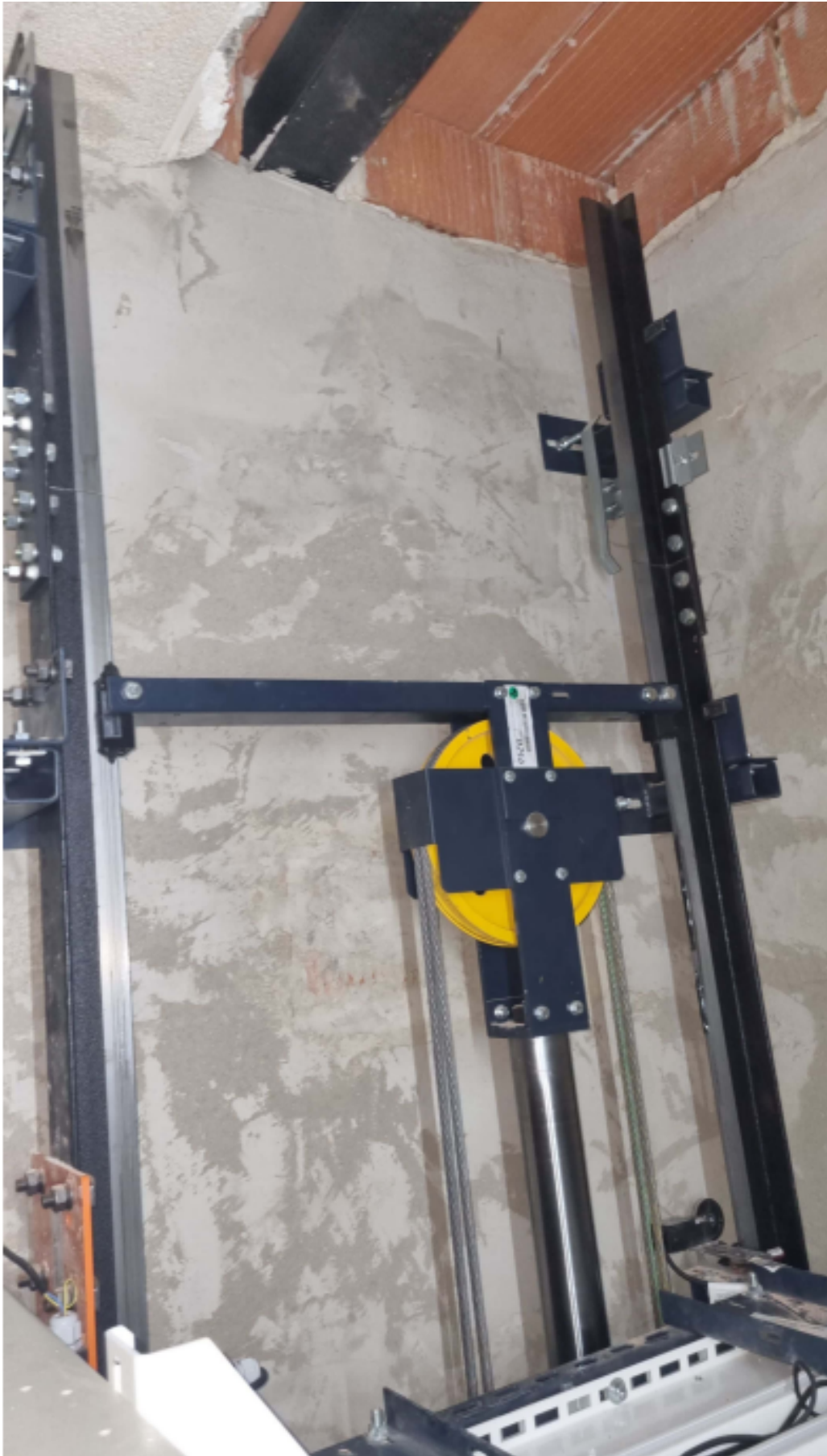
Figura 1.19: Imagen de la instalación
