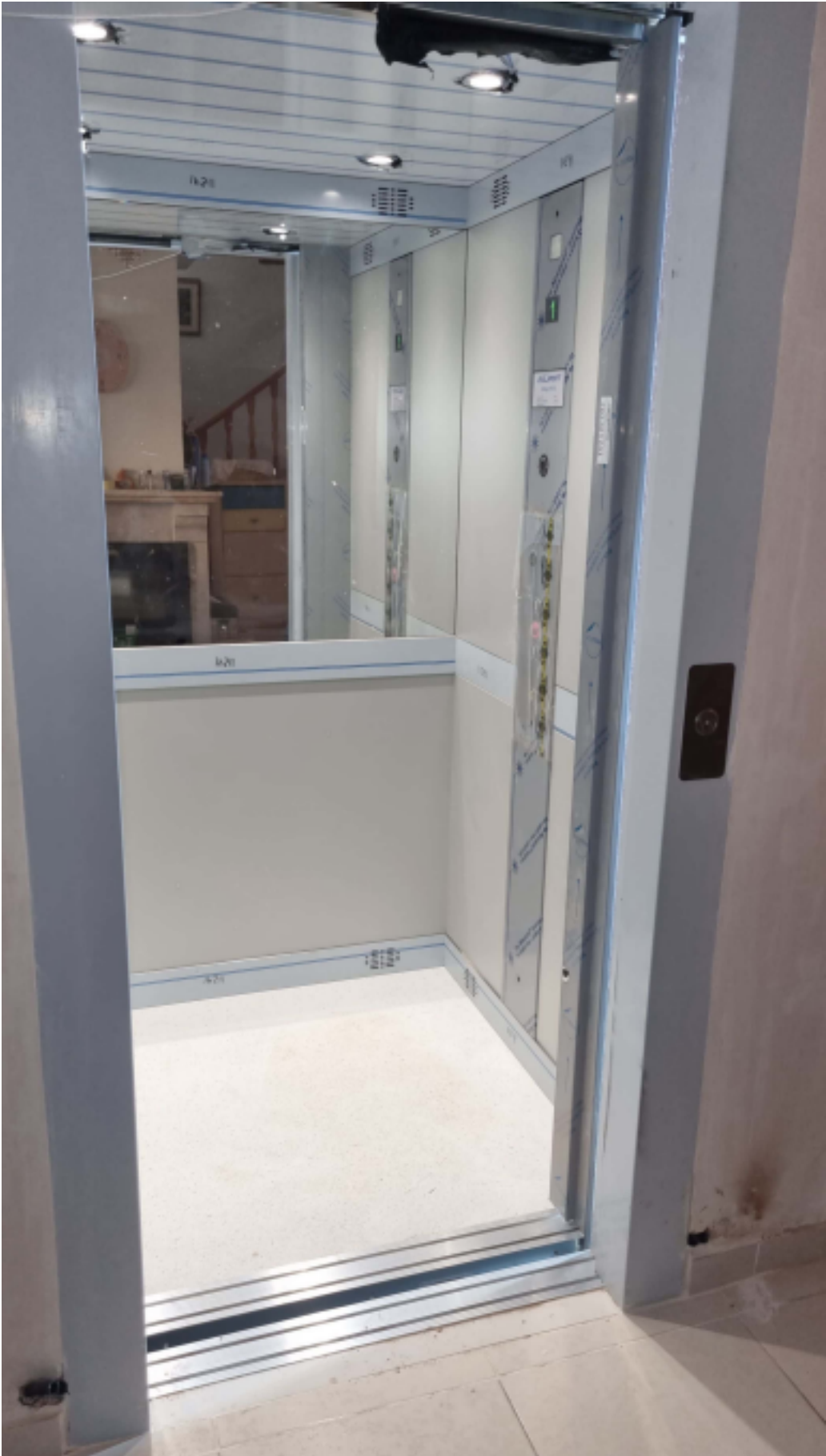
Figura 1.17: Imagen de la instalación
