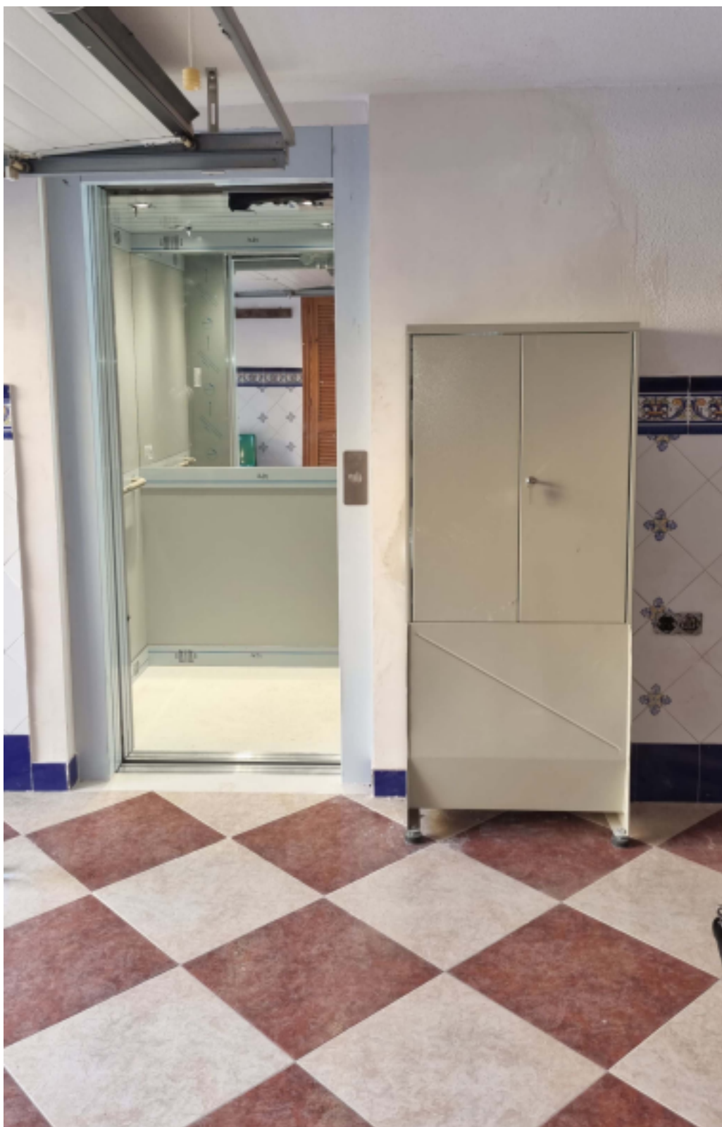
Figura 1.18: Imagen de la instalación
