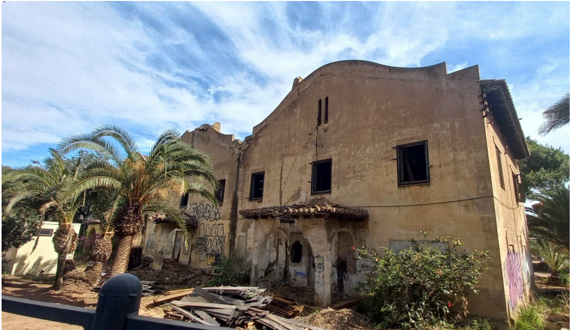
Figura 49. Pérdida parcial de pórticos, grafitis, cerramiento de vanos. Autora: H. Quintanilla (julio 2023).
