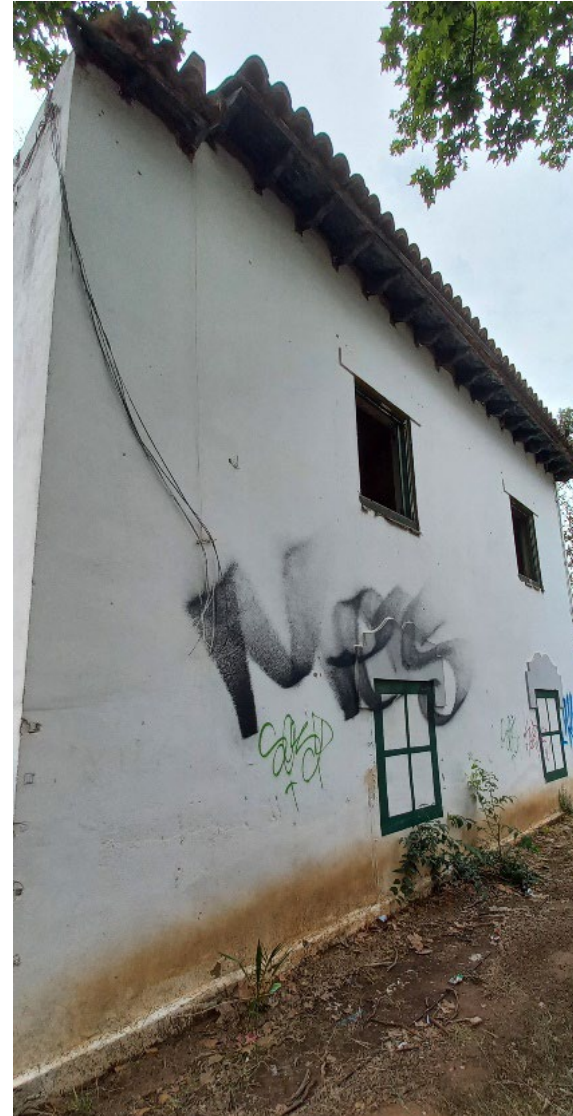
Figura 52. Fachada derecha con manchas en la base, grafitis, cerramiento de vanos. Autora: H. Quintanilla (mayo 2023).
