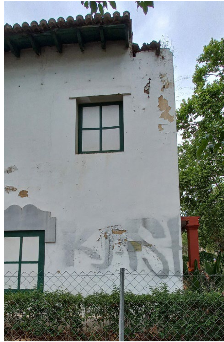
Figura 61. Fachada izquierda con grafitis, descamación del revoco, cerramiento de vanos y pérdida del tejado en la esquina superior derecha. Autora: H. Quintanilla (mayo 2023).
