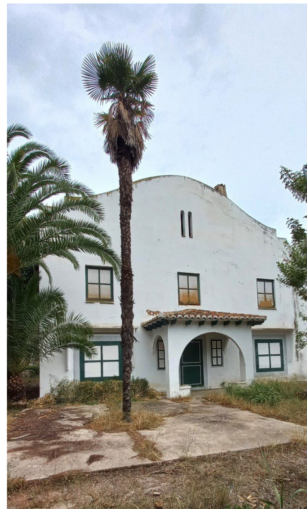
Figura 58. Chalet del extremo izquierdo (vista posterior), presenta depósito superficial en los cerramientos de vanos superiores. Autora: H. Quintanilla (mayo 2023).
