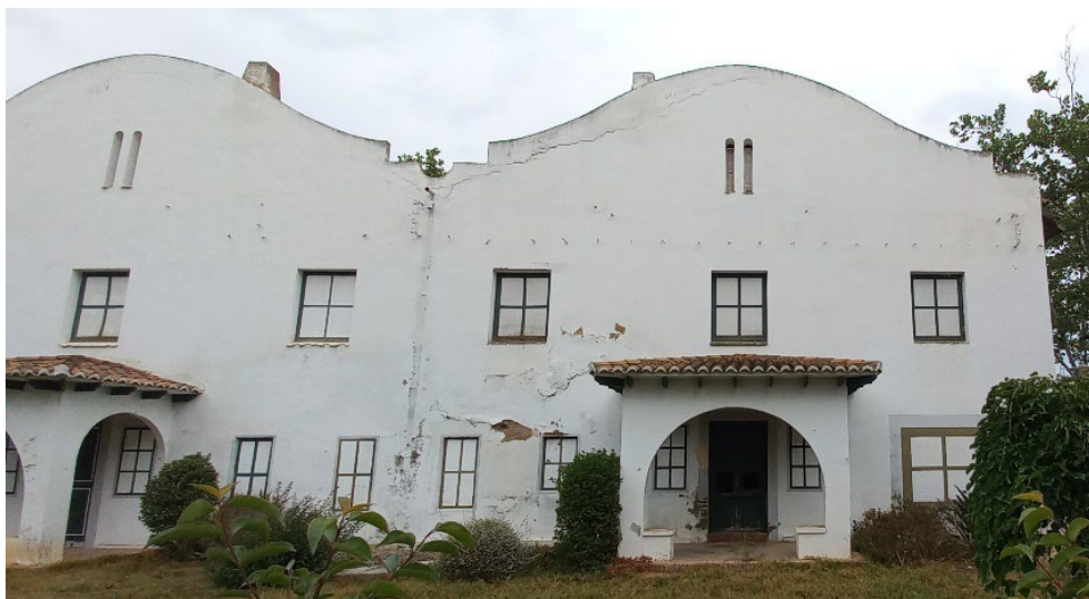
Figura 56. Fisuras, manchas, descamación, pérdida del revoco, cerramiento de vanos. Autora: H. Quintanilla (mayo 2023).
