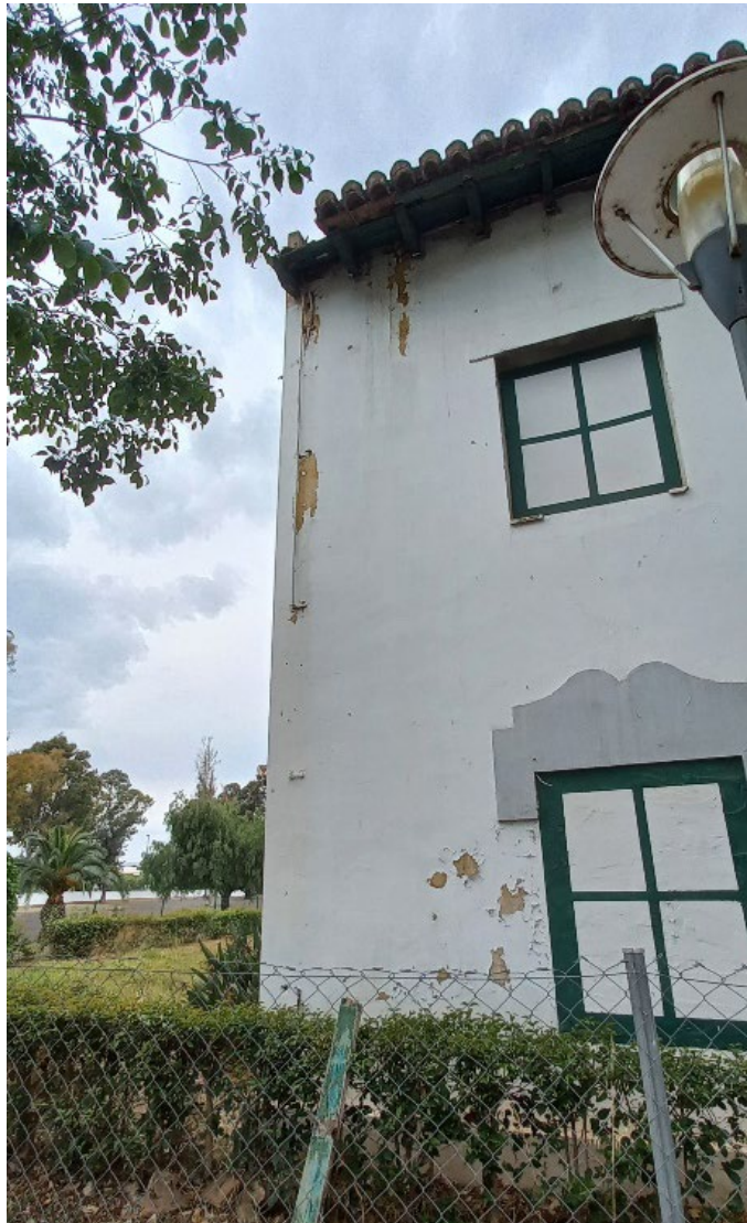
Figura 60. Fachada izquierda con desprendimientos y cerramiento de vanos. Autora: H. Quintanilla (mayo 2023).
