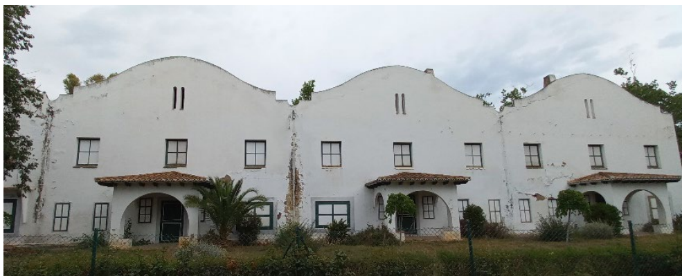
Figura 57. Descamación y pérdida del revoco, cerramiento de vanos, manchas. Autora: H. Quintanilla (mayo 2023).
