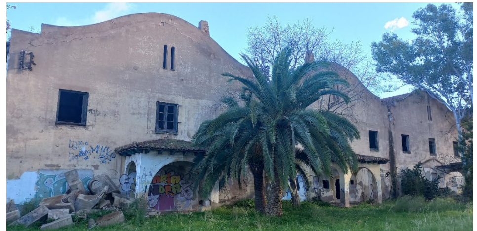
Figura 48. Fisuras en la fachada y pórticos, grafitis, cerramiento de vanos. Autora: H. Quintanilla (enero)
