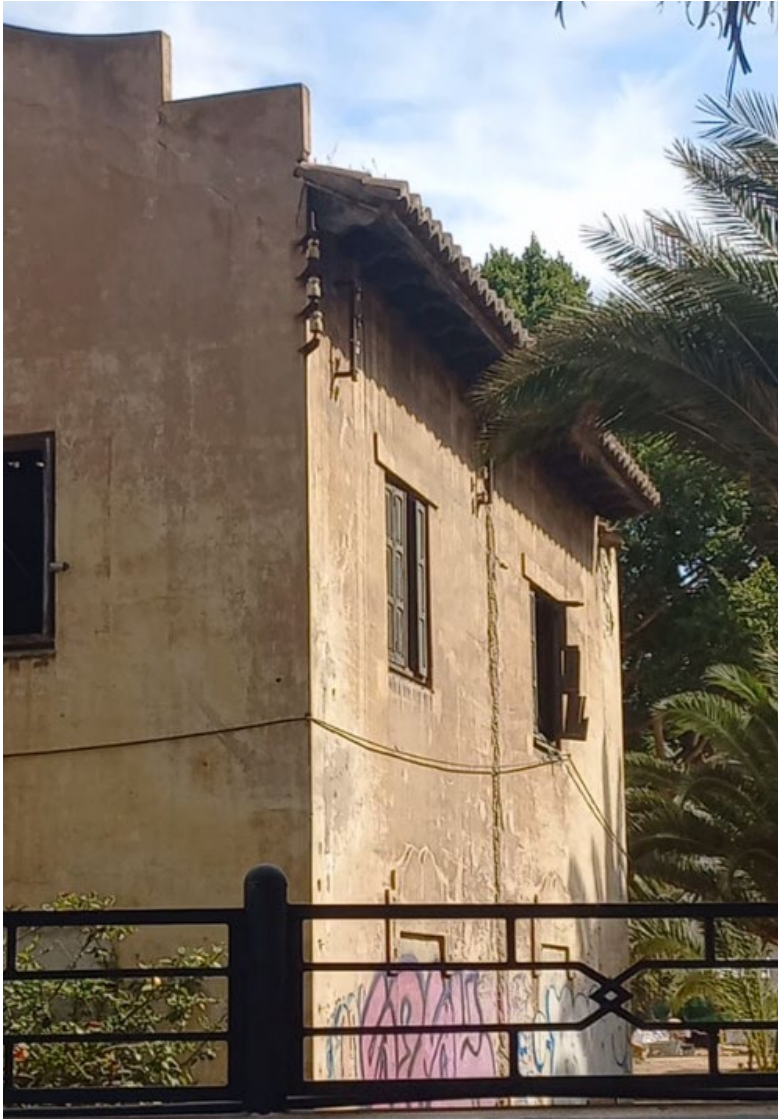
Figura 51. Fachada izquierda con manchas, grafitis, cerramiento de vanos. Autora: H. Quintanilla (julio 2023).
