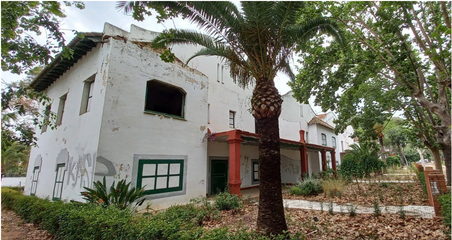
Figura 54. Fachada principal con manchas en la parte superior, cerramiento de vanos, pérdida de balaustrada y parte del tejado. Autora: H. Quintanilla (mayo 2023).
