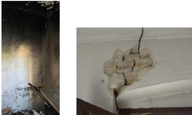
Figura 66. Asiento diferencial de la cimentación. Fuente propia
