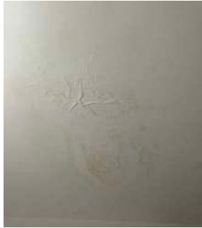
Figura 71. Humedad por filtración en bovedilla. Fuente propia
