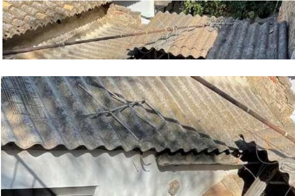
Figura 145. Elementos de fibrocemento que contiene amianto en vivienda. Fuente propia
