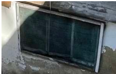
Figura 70. Humedad por filtración por ausencia de vierteaguas. Fuente propia
