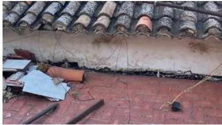
Figura 138. Mala colocación impermeabilización encuentro muro de cubierta transitable. Fuente propia
