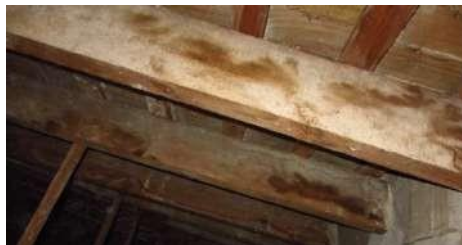
Figura 68. Humedad por filtración en cubierta. Fuente propia
