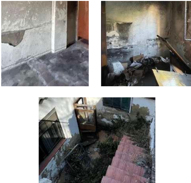
Figura 63. Humedad por capilaridad. Fuente propia
