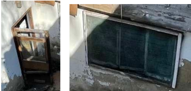
Figura 73. Falta de estanqueidad y aislamiento en carpinterías. Fuente propia
