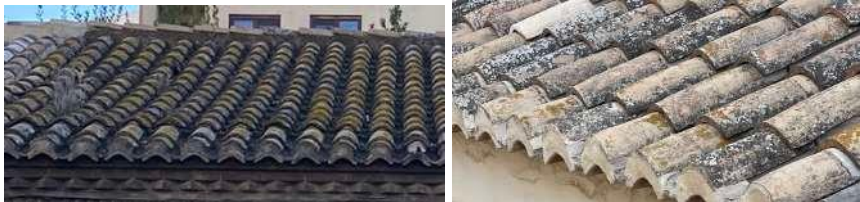
Figura 65. Agentes bióticos en cubierta principal y posterior de la vivienda existente. Fuente propia
