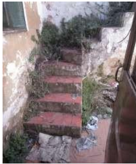
Figura 64. Agentes bióticos en patio interior vivienda. Fuente propia
