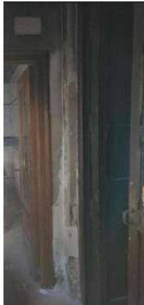
Figura 67. Desprendimiento en base de testa y alzado de muro de carga. Fuente propia
