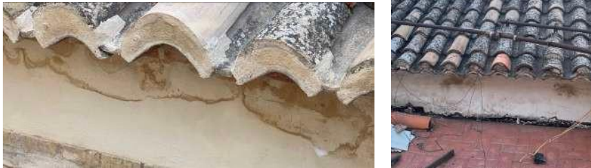
Figura 69. Humedad por filtración bajo alero. Fuente propia
