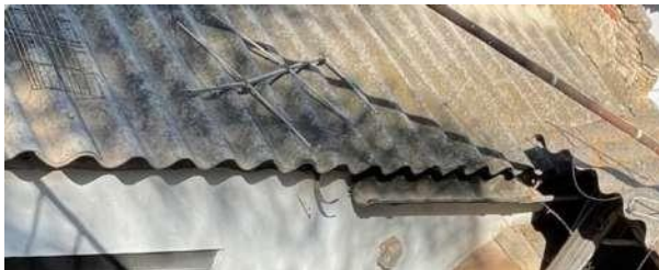
Figura 74. Lesión en canalón en patio de luces. Fuente propia
