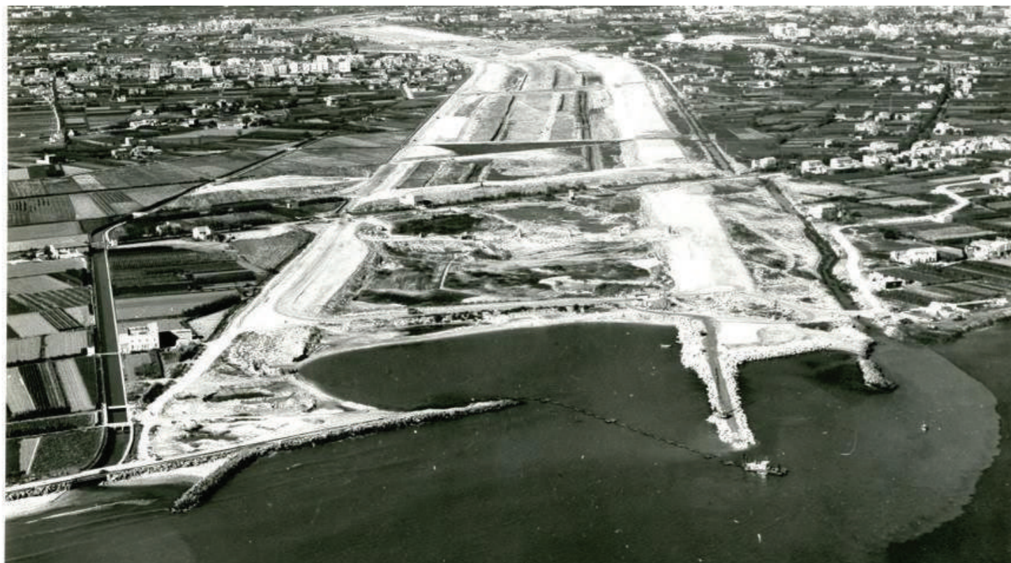
Actuaciones para el desvío del cauce del río Túria en la nueva desembocadura, en 1968. Fuente: Confederación Hidrográfica del Júcar
