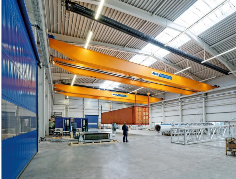
Figura 26.- Puente grúa de tipo birrail. Fuente: ABUS, sistemas de grúas
