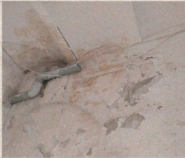
Img. 40 Signos de deterioro en el encuentro con una bajante.
